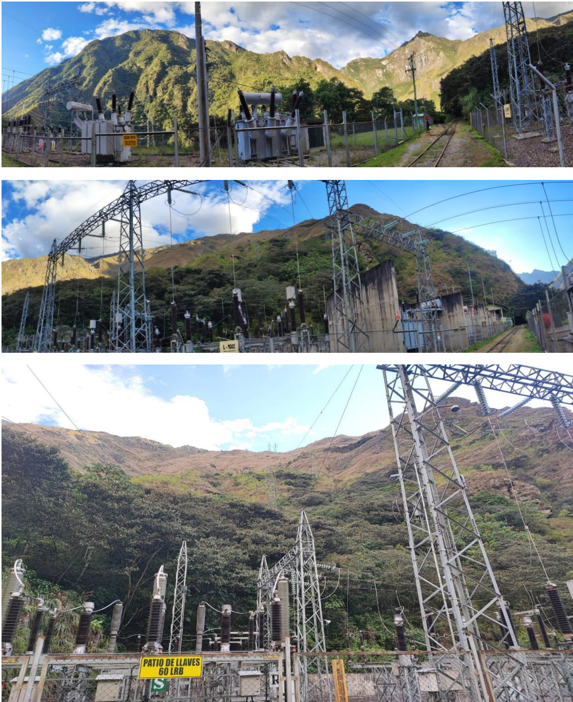
Figura N° 66: Patio de llaves y sala de mandos
