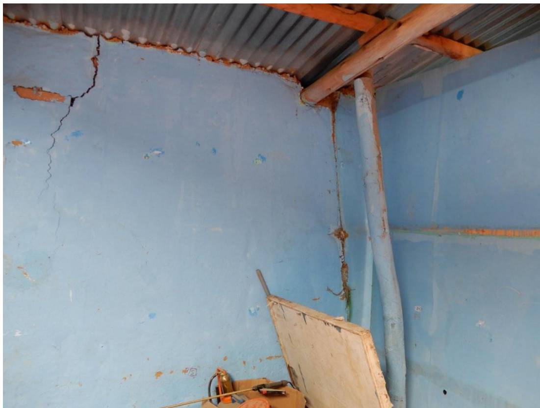
Fotografía 9. Fisuras en el parte superior izquierdo de la pared de una de las aulas de la I.E Huanín nivel secundario (386,218.95E; 8,905,667.90N m).
