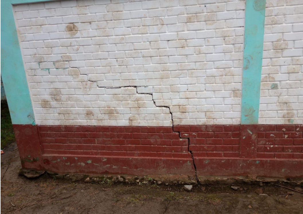
Fotografía 12. Deslizamiento en desarrollo que afecta el aula de la I.E 32632, manifestándose con grietas y fisuras que atraviesan la pared.
