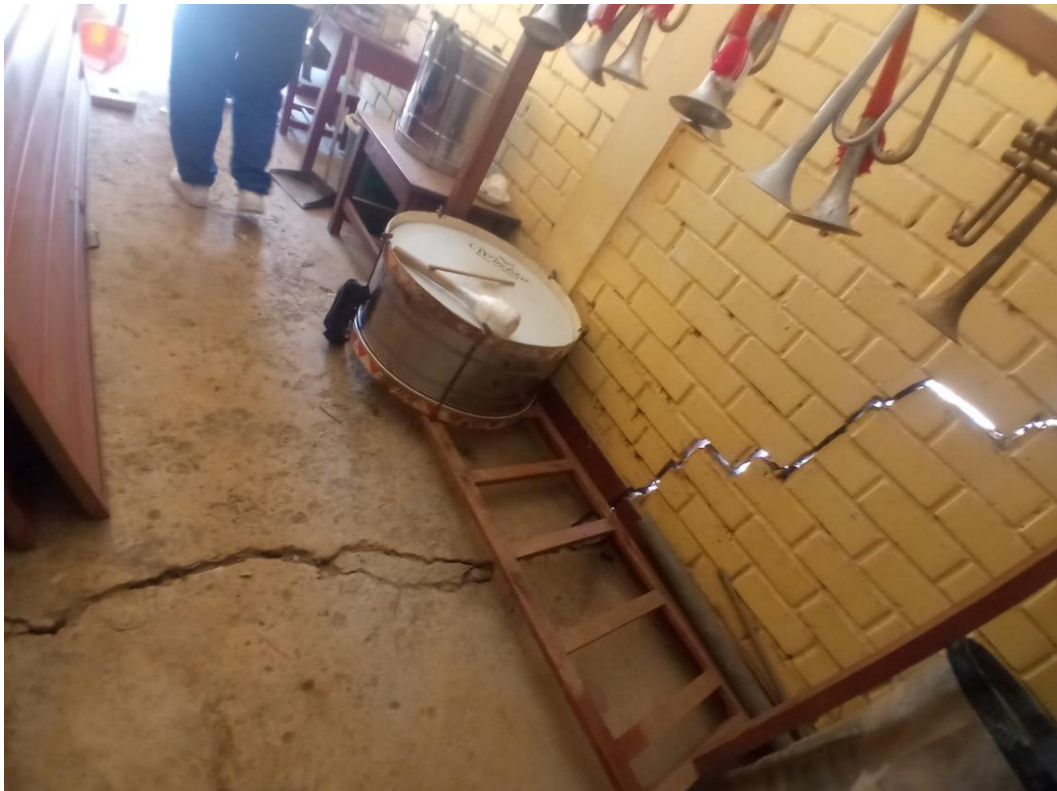
Fotografía 13. Grietas de tensión que atraviesa el almacén de la I.E 32362, lo que revelan deformaciones internas de la superficie, situadas en el cuerpo de un antiguo deslizamiento.
