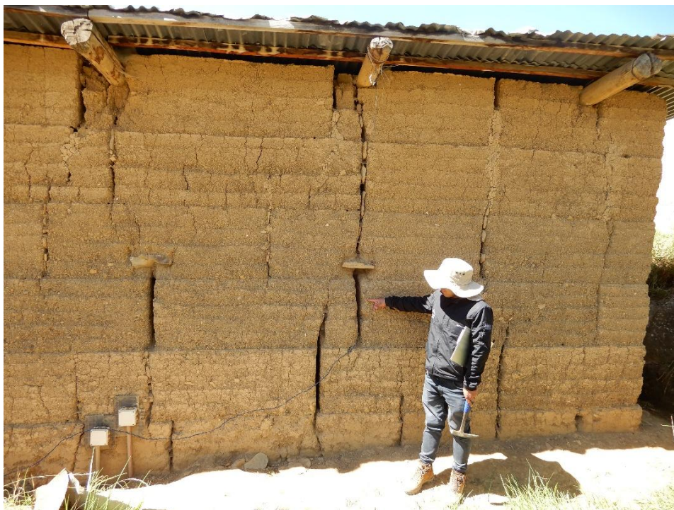
Fotografía 10. Fisuras en la pared posterior del aula, donde se aprecia grietas confinadas a una mala calidad de la construcción. Estas grietas no presentan continuidad y proyección hacia el terreno llano (386,212.22E 8,905,659.65N m).
