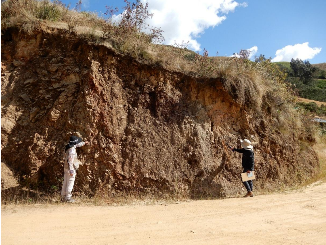
Fotografía 1. Rocas metamórficas de esquistos de cuarzo y micas del Complejo del Marañón muy fracturadas y fuertemente meteorizadas, ubicadas encima de la corona del deslizamiento antiguo. Vista en dirección norte (385,979.00E 8,905,237.81N m).
