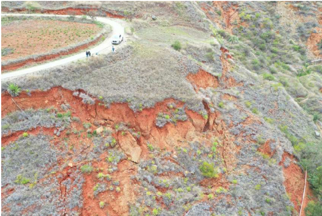
Fotografía 4. Escarpe (e2) y su propagación hacia la parte superior de la ladera. Nótese, el límite del escarpe a pocos metros de la trocha carrozable. Vista área en dirección este.
