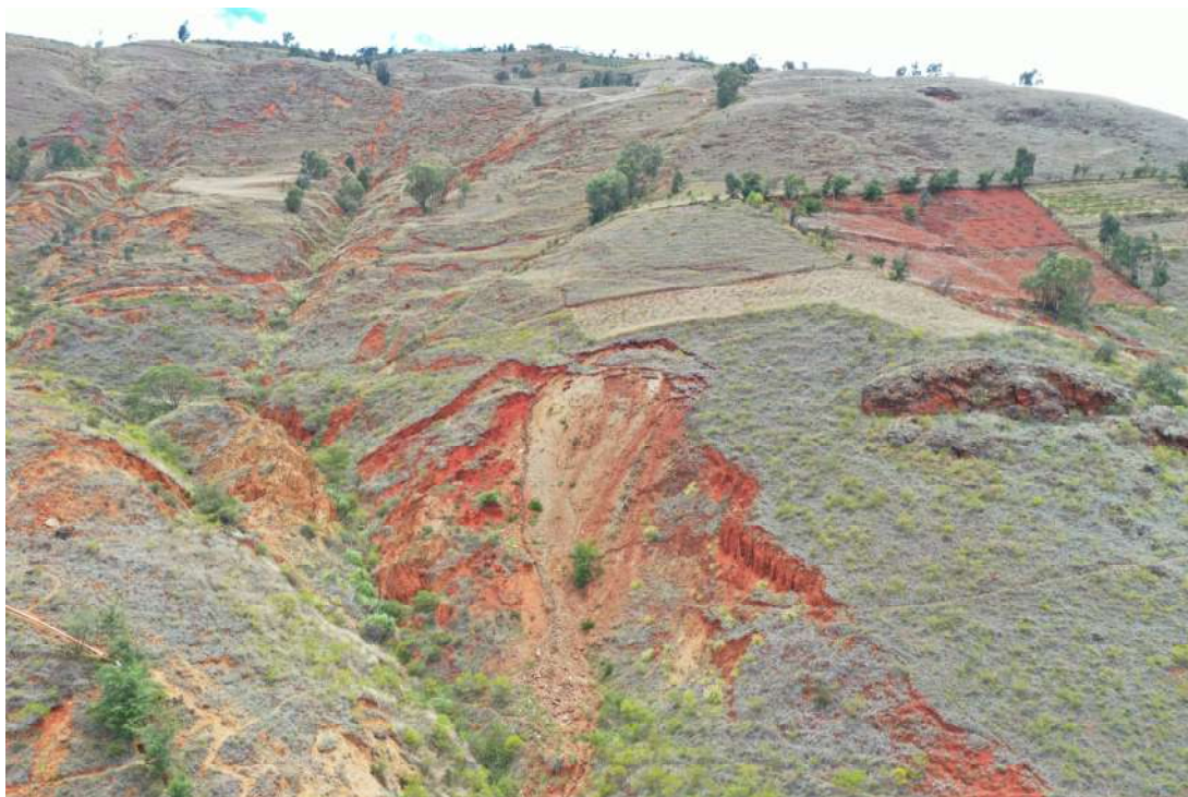
Fotografía 9. Deslizamiento (D4) que afecta el flanco izquierdo del deslizamiento principal (D1) de la ladera del cerro Pachamuña. Vista área en dirección noreste.
