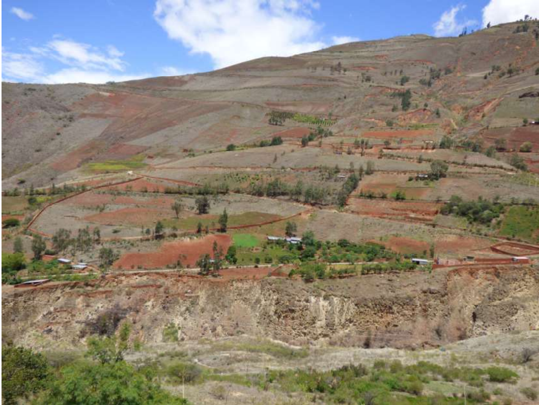
Fotografía 13. Corte de carretera sobre la ladera media-baja del cerro Pachamuña, el cuál ocasiona pérdida progresiva del equilibrio estructural de dicha ladera.
