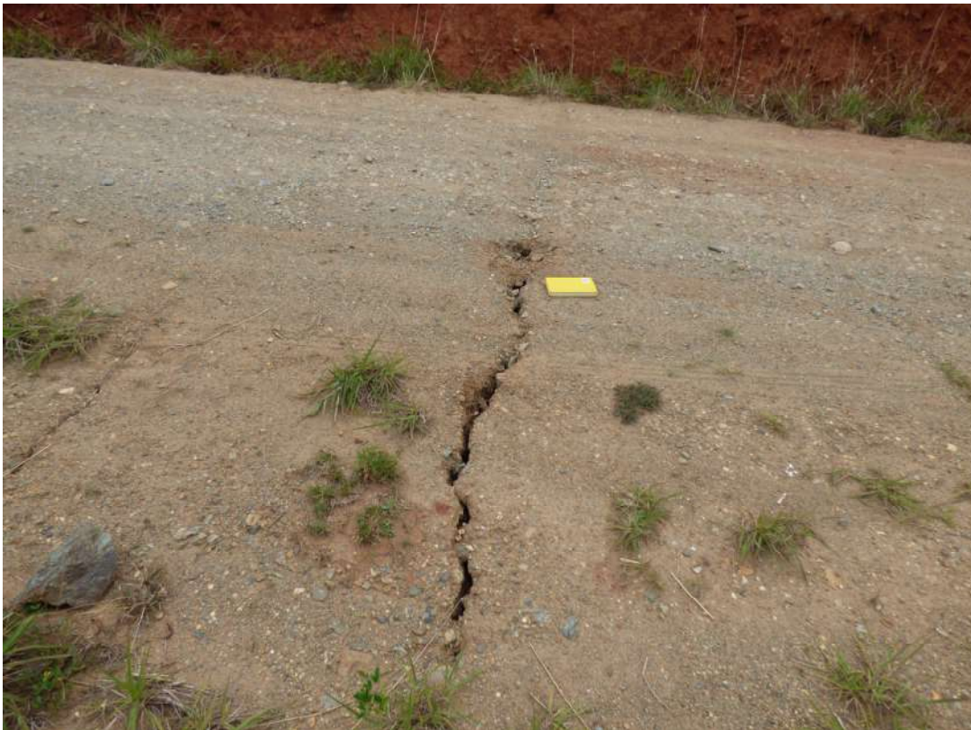
Fotografía 6. Grieta que atraviesa transversalmente la vía vecinal. La zona representa la proyección lateral del escarpe (E2).
