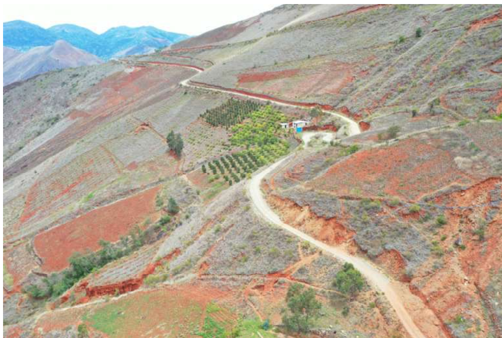
Fotografía 10. Al fondo se observa terrenos agrícolas con árboles frutales que requieren grandes cantidades de agua. La práctica de riego por gravedad ocasiona saturación del terreno, el cual induce a la pérdida progresiva de la resistencia al corte del suelo.
