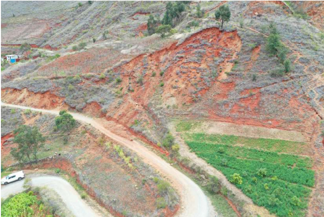
Fotografía 7. Escarpe (e3) dentro del cuerpo principal del deslizamiento, que afecta la trocha carrozable y terrenos agrícolas. Vista área en dirección norte.
