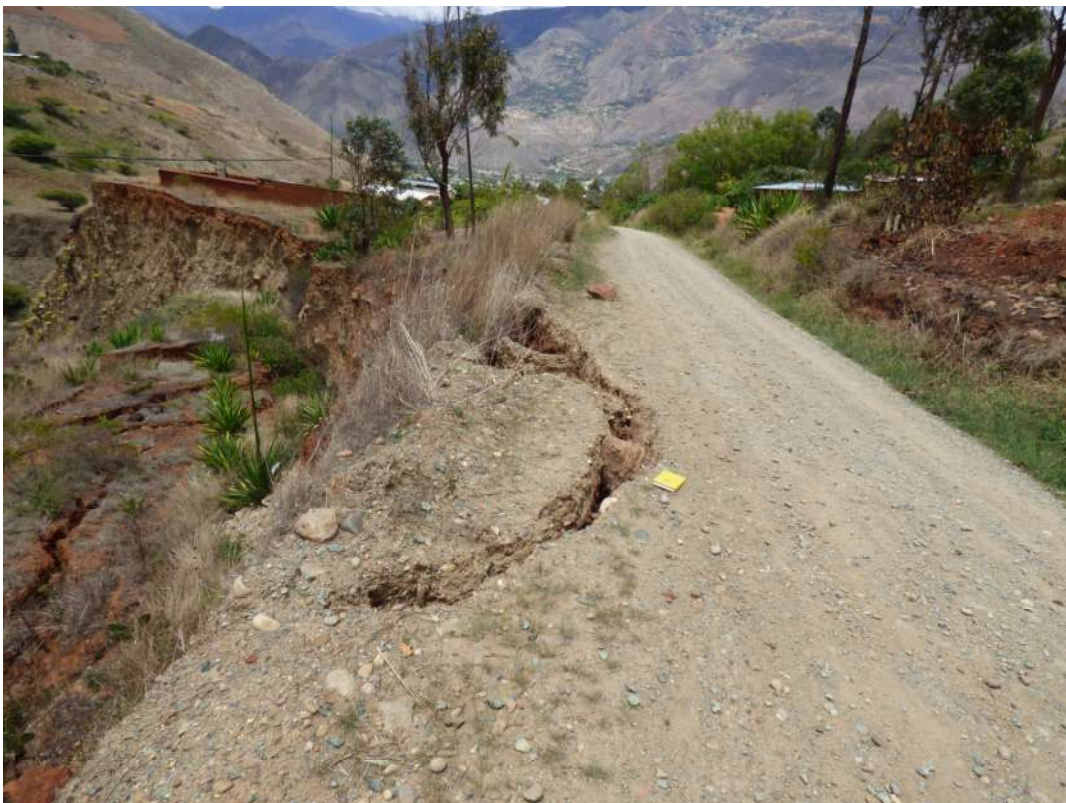
Fotografía 8. Deslizamiento (D2) sobre la margen derecha de la quebrada Utijmayo. Se observa una grieta profunda que evidencia el estado activo y el avance retrogresivo que compromete la vía vecinal hacia el poblado de Mirachi. Vista en dirección noroeste.
