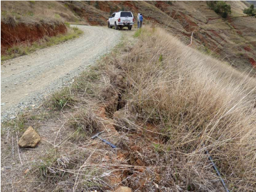
Fotografía 5. Grieta profunda sobre el escarpe (E2) que compromete la vía vecinal que se dirige hacia el poblado Mirachi. Vista en dirección sureste.
