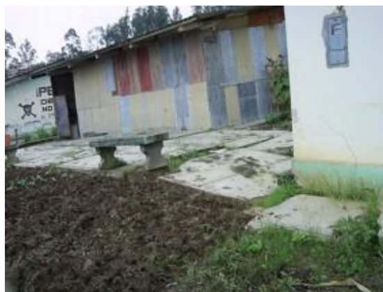
Fotografía 13: Levantamientos y hundimientos en los pisos del hospital de IPSS.
