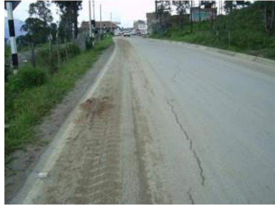
Fotografía 6: Agrietamientos y asentamientos en el asfalto de carretera.
