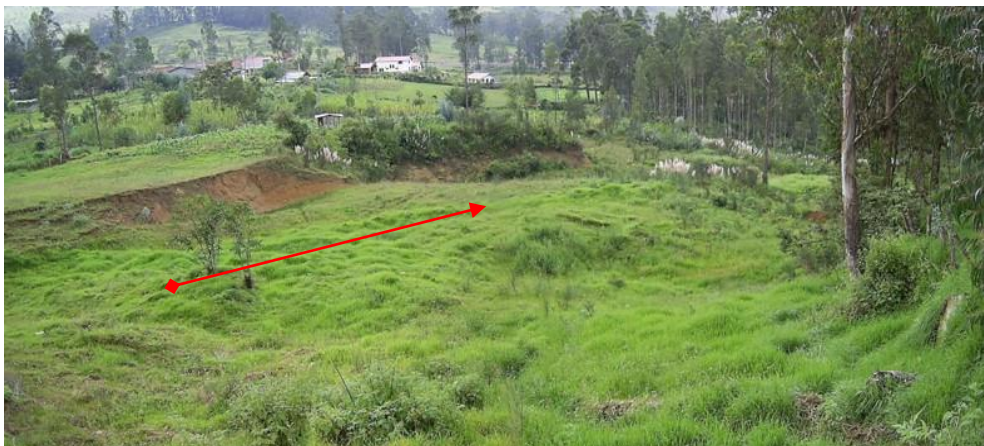
Fotografía 4: Cuerpo del movimiento complejo donde se observa la dirección de flujo y el terreno irregular.
