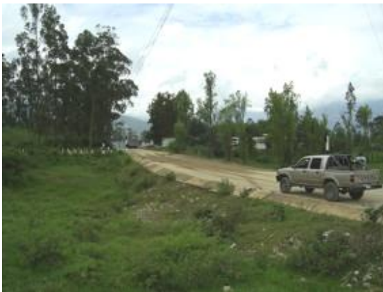
Fotografía 9: Vista de la plataforma de carretera, el relleno que se ha realizado para su construcción, y la pérdida de asfalto producida.
