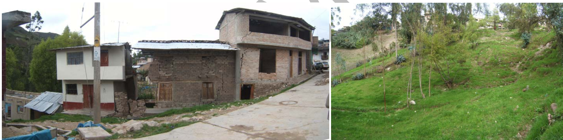
Barrio de Cinco Esquinas, Bambamarca. Deslizamiento en la parte inferior del pueblo que afecta unas 35 viviendas del sector. Algunas de las casas están rehabilitadas, la zona ha sido considerada inhabitable y en emergencia.
