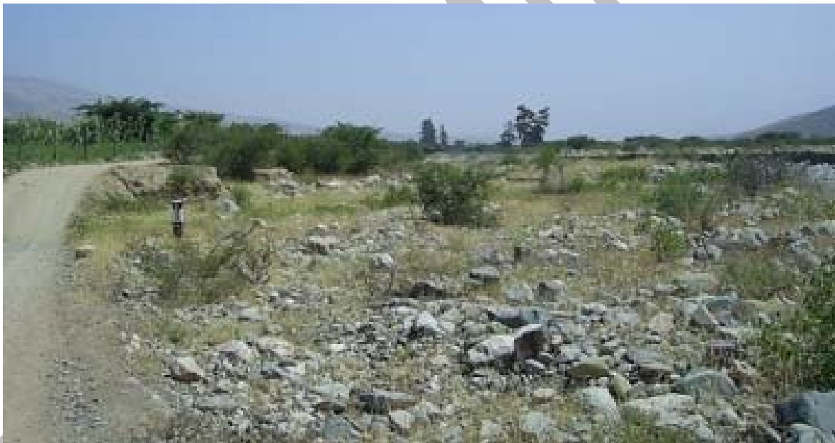
Sector el Mango afectado por erosión fluvial de manera excepcional, en la margen derecha del río San José, San Gregorio.
