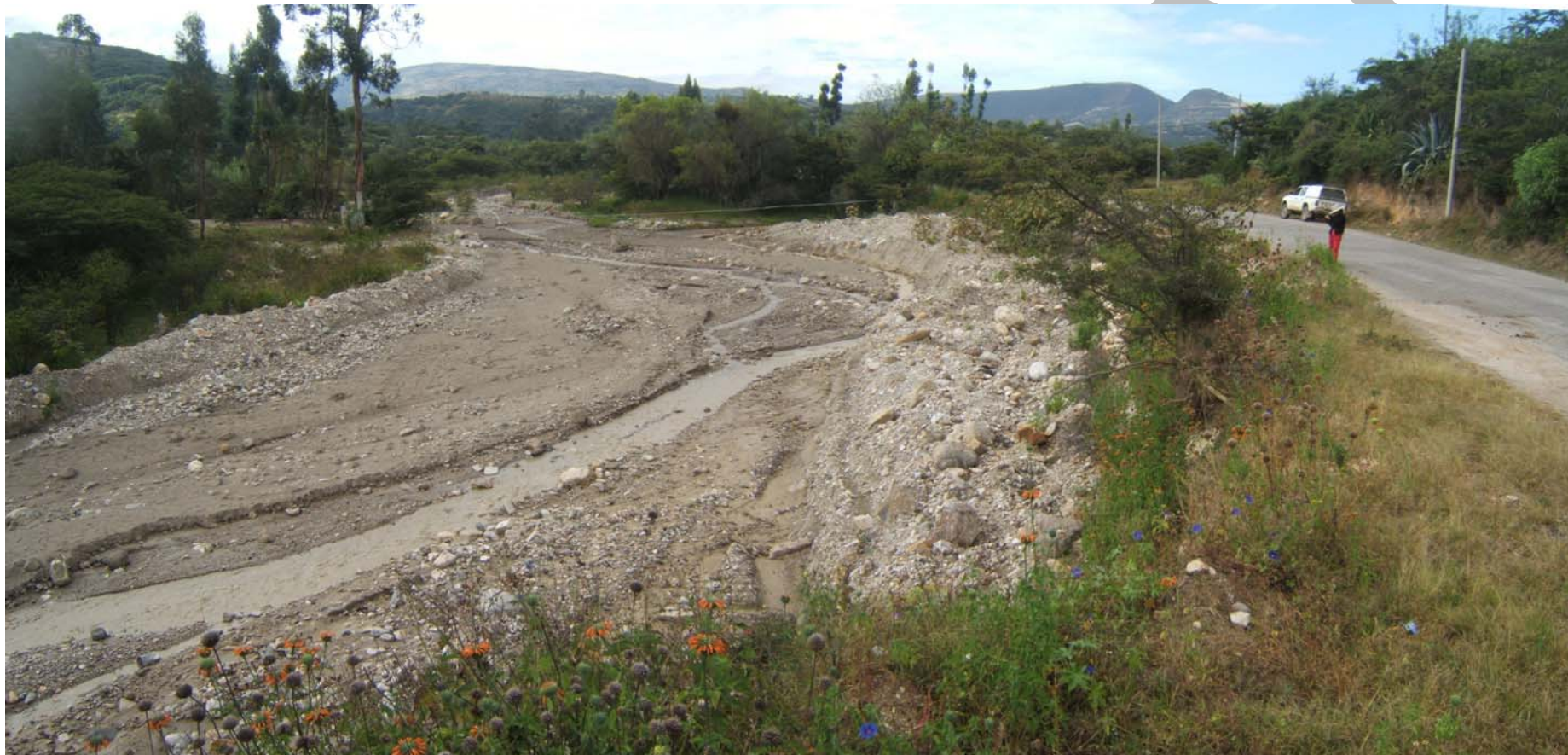
Erosión fluvial en las márgenes de la quebrada Honda, El Cedro que compromete un tramo de la carretera entre San Marcos e Ichocán.
