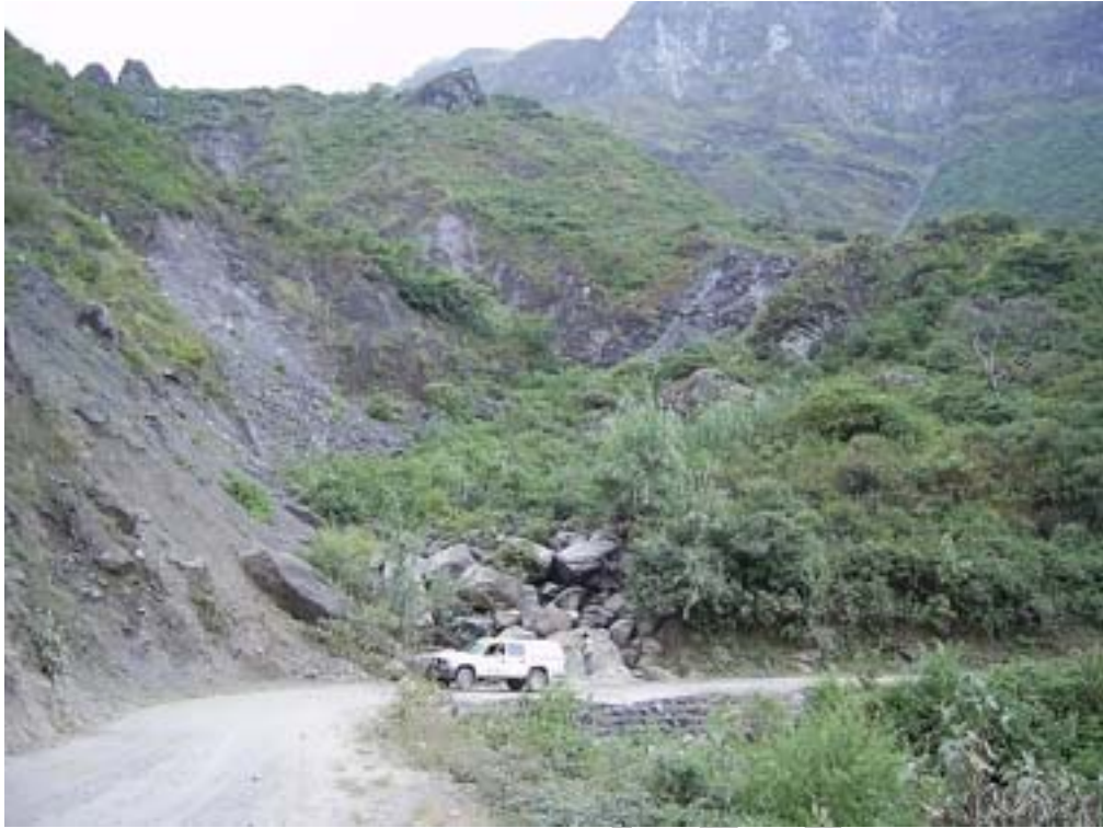
Sector el Palto, en la carretera San Pablo-San Miguel de Pallaquez, afectado por huaycos y deslizamiento en la plataforma de carretera.
