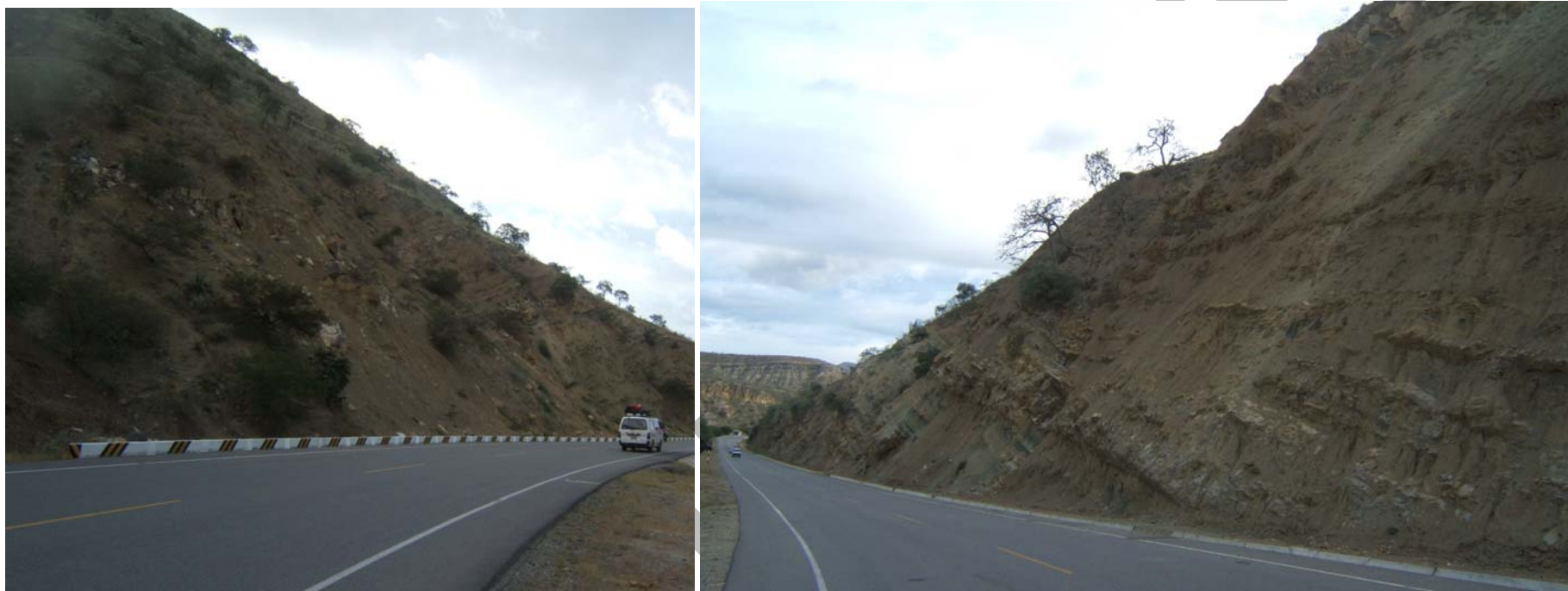
Km. 185 al 190 de la carretera Olmos-Corral Quemado. Taludes de corte de carretera propensos a caída de rocas, vuelcos y derrumbes.
