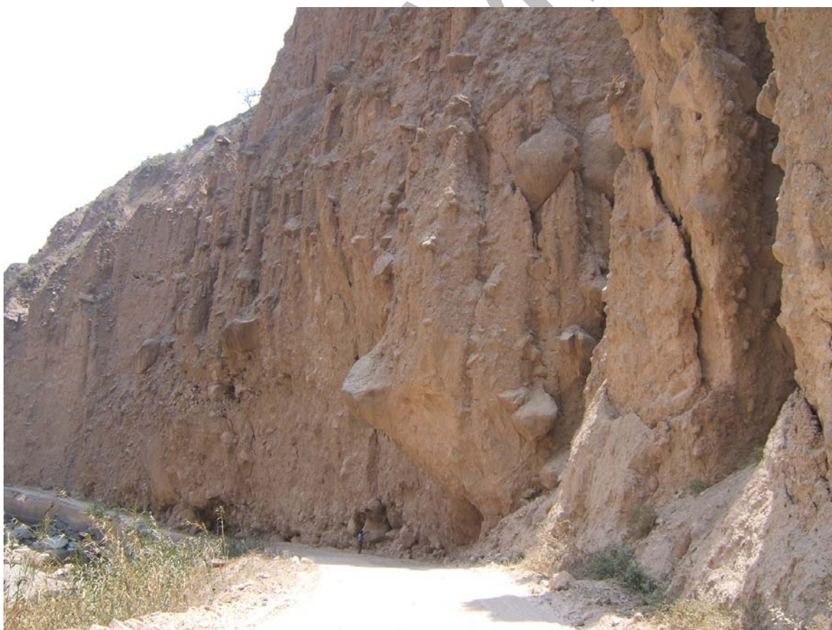
Derrumbes que afectan tramo de la carretera Chongoyape-Santa Cruz, en el sector Cumbil-Cirato (Distrito de Llama, provincia de Chota)
