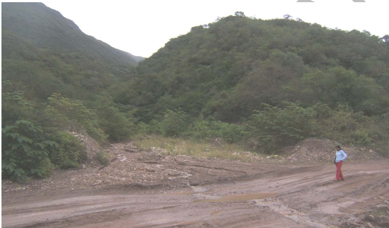
Sector cercano a Boca Chirinos afectada por flujo de detritos periódico que afecta un tramo de 150 m de la carretera entre Jaén y San Ignacio.
