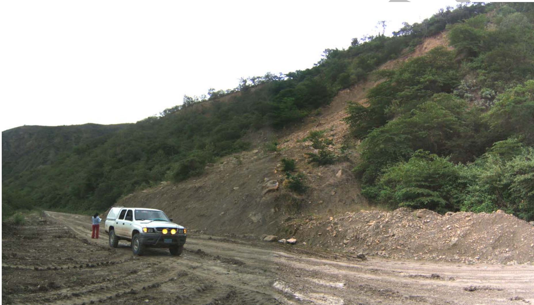
Deslizamiento traslacional en el talud superior de carretera entre Jaén y San Ignacio, cerca del paraje Chuchuhuasi
