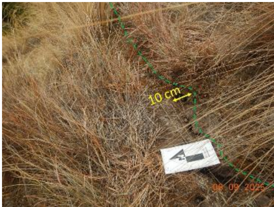
Figura 14: Vista de una grieta retrogresiva ubicada por detrás del cuerpo del deslizamiento.
