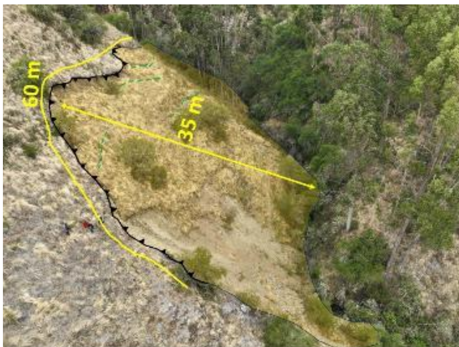
Figura 12: Vista de las dimensiones del deslizamiento, donde la base se encuentra en el cauce de la quebrada Miskiuno.
