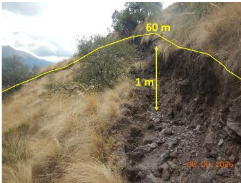
Figura 11: Vista de las dimensiones del deslizamiento. La cabecera se ubica a media ladera del sector de Negro K'aka.
