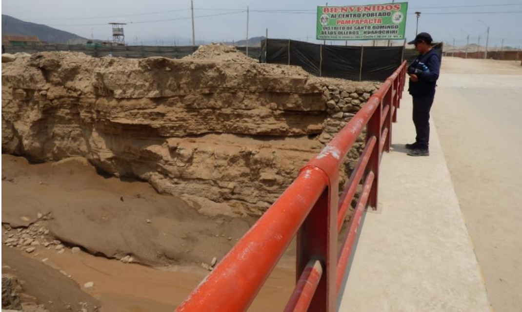
Fotografía 2. Puente “Manuel Valdivia Valle” después del flujo del 27 de febrero del 2025. Coordenadas UTM E:305220; N:8638323
