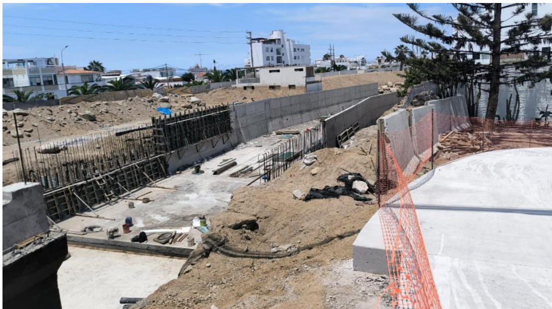
Fotografía 6. Trabajos de encauzamiento de la quebrada. Imagen tomada en febrero 2026. Vista hacia el SO.
