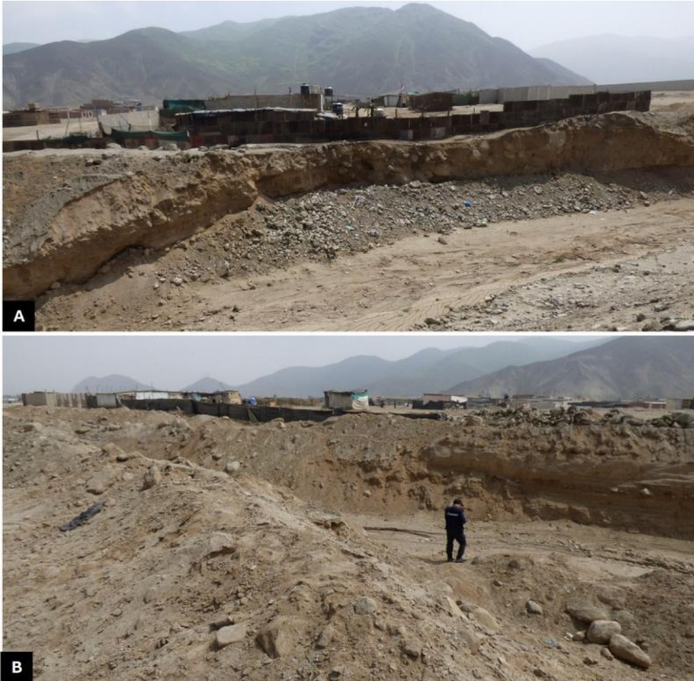
Figura 17. A. Viviendas muy cercanas a la margen derecha del cauce, se observa la inestabilidad producto de la erosión. B. Se observa material depositado en ambas márgenes.
