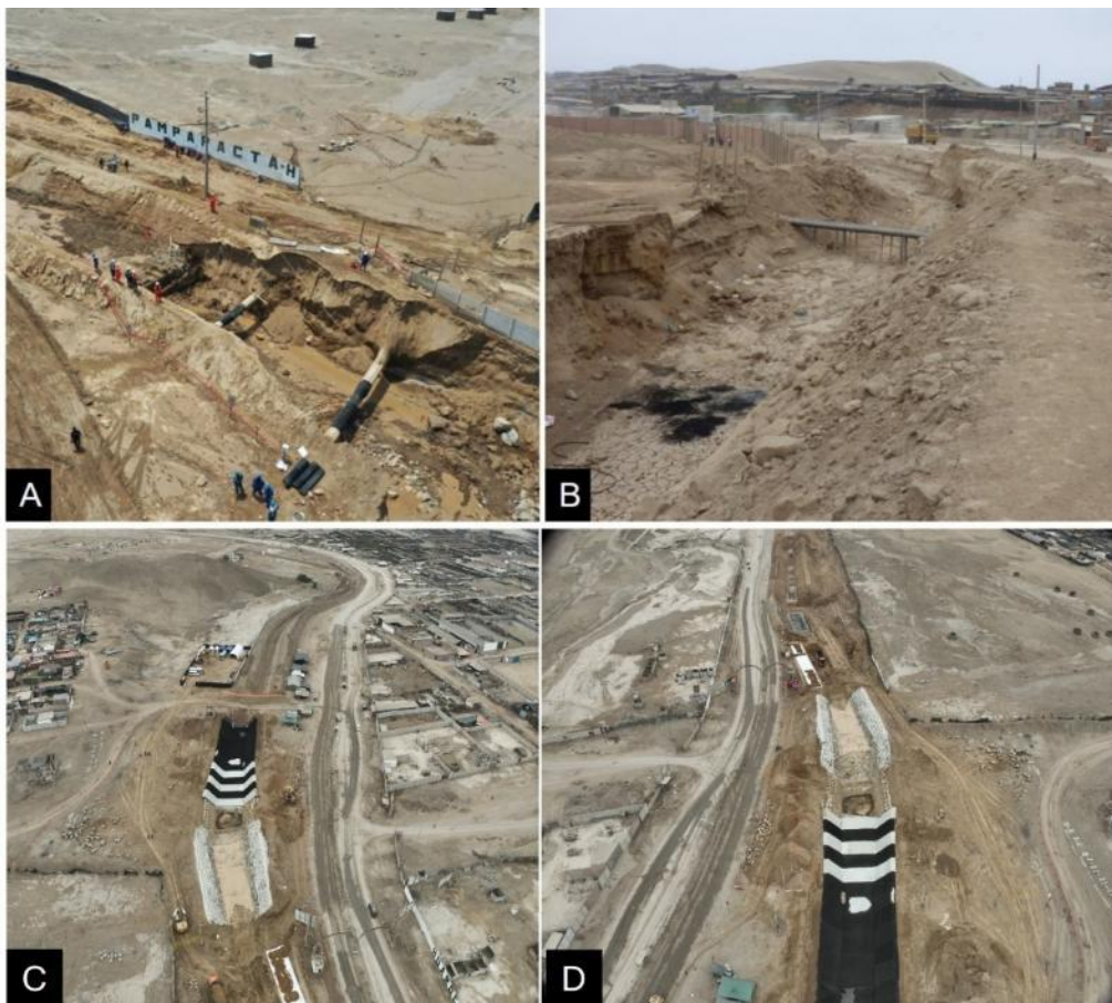
Figura 20. A y B son imágenes posteriores al flujo de lodo ocurrido en marzo del año 2023, se muestran expuestas las tuberías de Calidda. C y D muestran los trabajos que se realizan actualmente (2025) sobre las tuberías con la finalidad de protegerlas.
