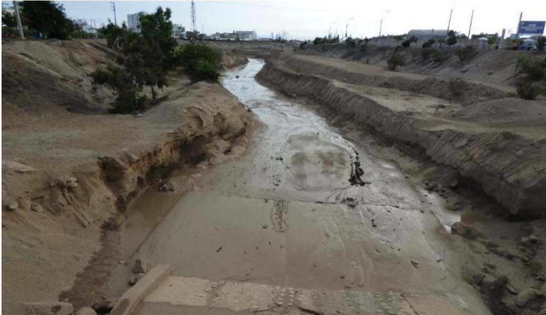
Fotografía 5. Depósito proluvial en el curso de la quebrada. Vista en dirección SO hacia su desembocadura, se observan sectores de erosión. Tomada desde la carretera Panamericana Sur el 28/02/2025.
