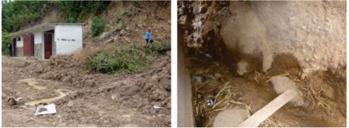
Foto 19. Se aprecia las filtraciones de agua y el humedecimiento del suelo, en la parte urbana.
