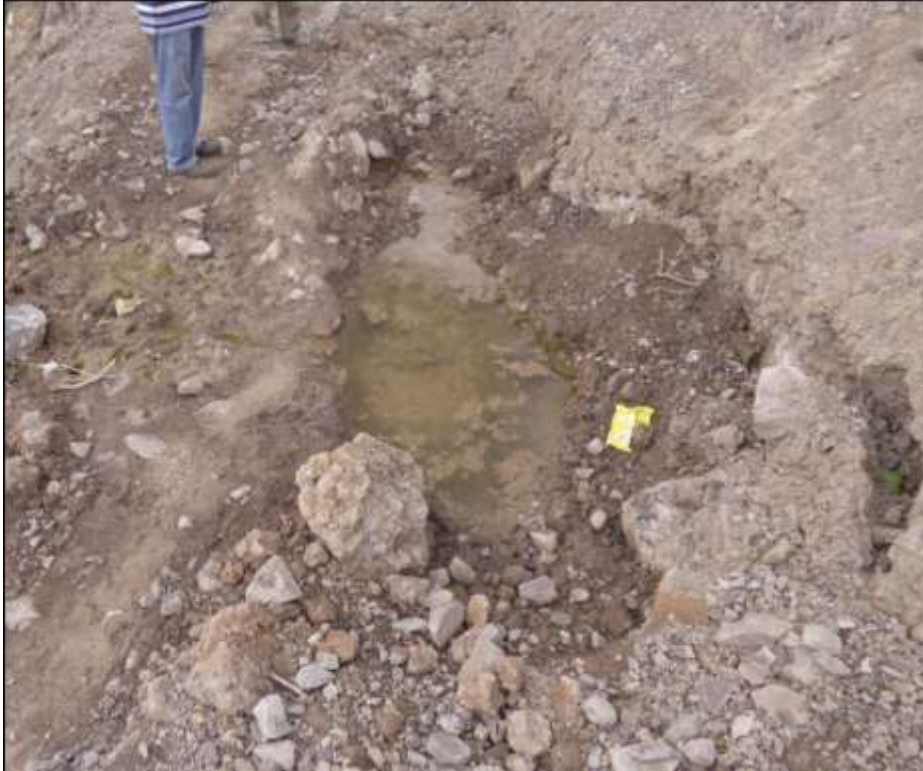
Foto 11. Se muestra puquial, proveniente de filtraciones de agua subterránea, no tiene un drenaje adecuado.
