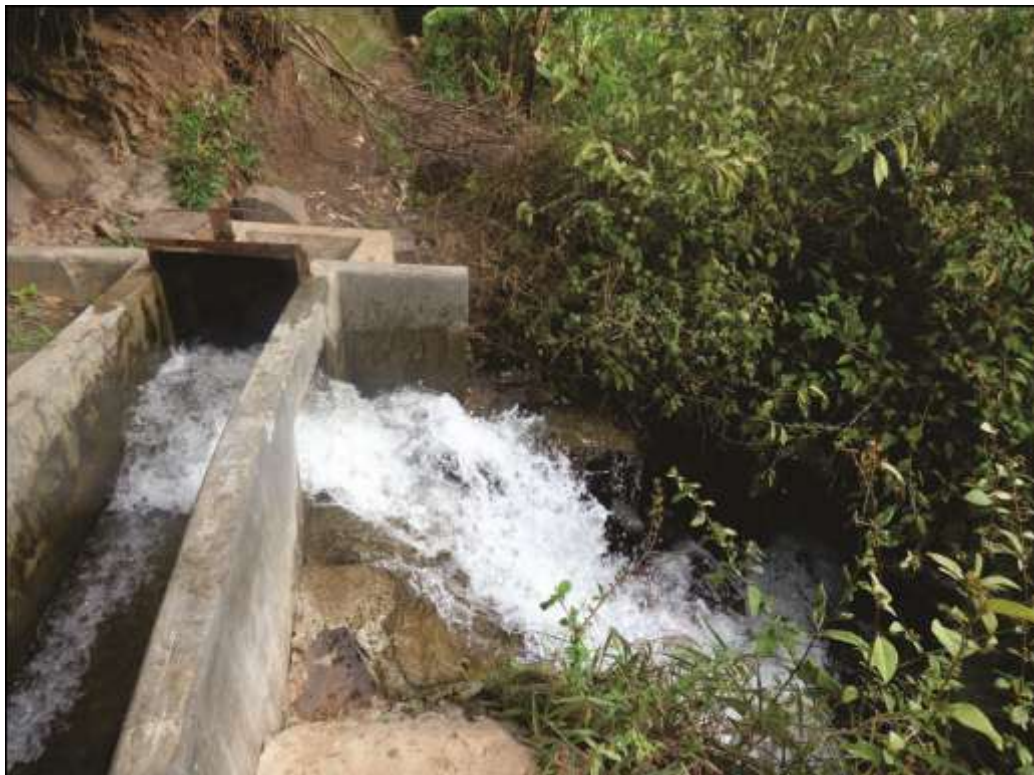
Foto 18. El agua es vertida en forma no adecuada a la ladera.
