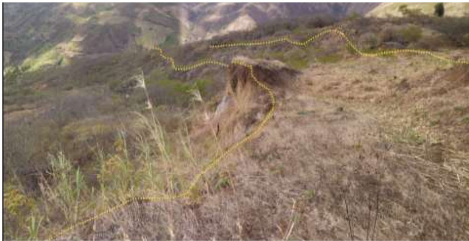
Foto 13. Escarpes secundarios en la parte alta del deslizamiento, se aprecia el basculamiento del terreno.
