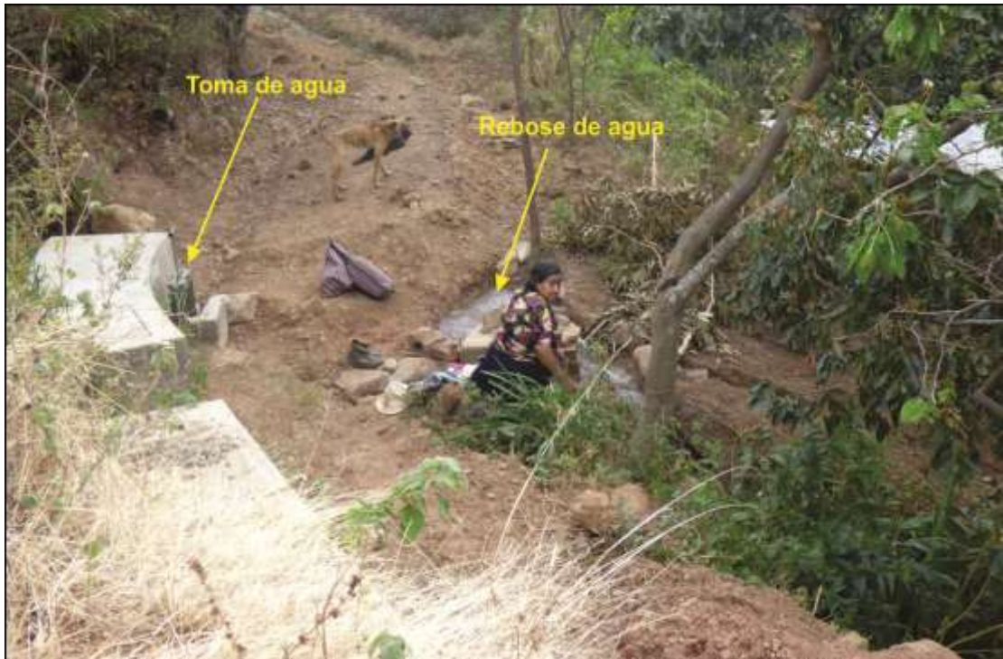
Foto 17. Rebose de agua, proveniente del mal estado de la toma de agua.
