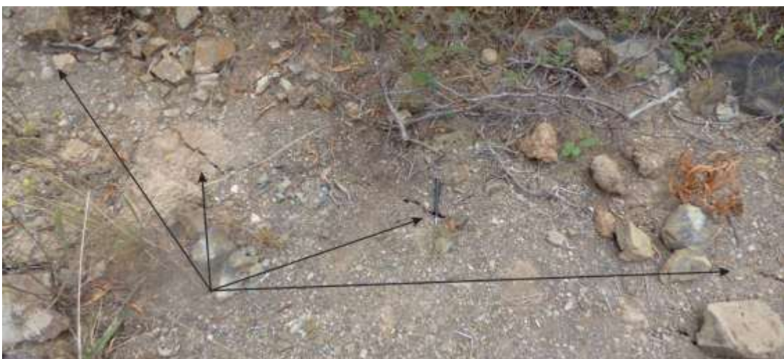
Foto 6. Se aprecian los agrietamientos del terreno, ubicados detrás del escarpe principal.
