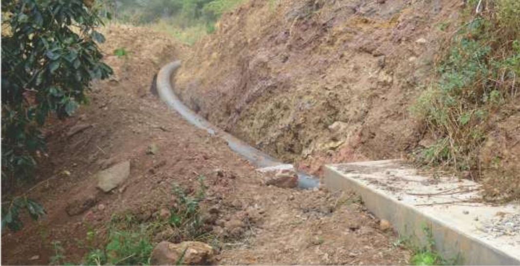
Foto 15. Tubería de agua de regadío, está siendo afectada por el empuje del terreno.
