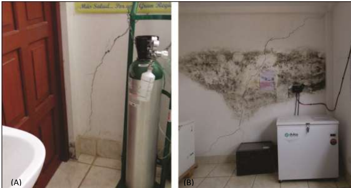
Fotos 21A y 21 B. Paredes de posta médica, con fisuras.
