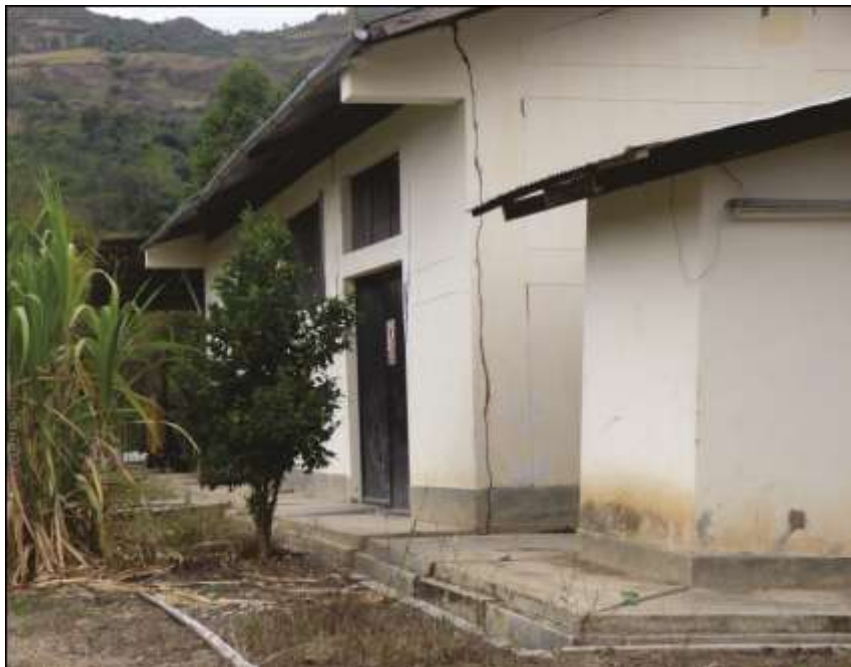
Foto 20. Se aprecia paredes de la mini central hidroeléctrica con agrietamientos.
