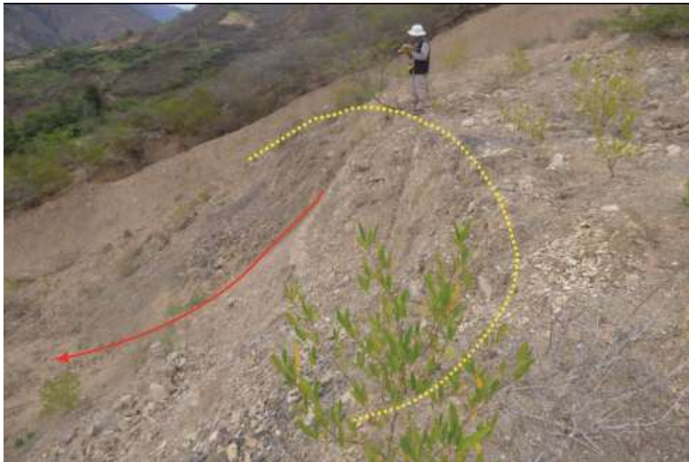
Foto 8. Se aprecia el escarpe secundario y la pendiente del terreno.
