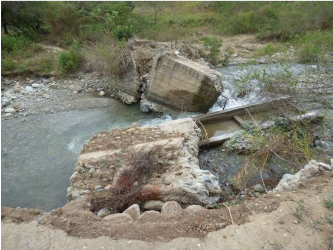
Foto 23. En el año 2011, el puente fue destruido por erosión fluvial, debido a una crecida extraordinaria del río Sallique
