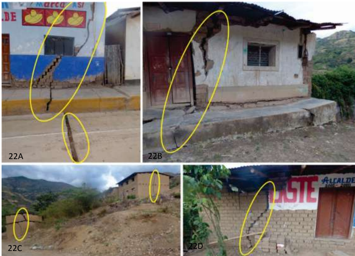
Fotos 22A, 22B, 22C y 22D. Paredes agrietadas. En la vista 22A, se aprecia también la vereda y loza con agrietamiento y desplazamiento.
