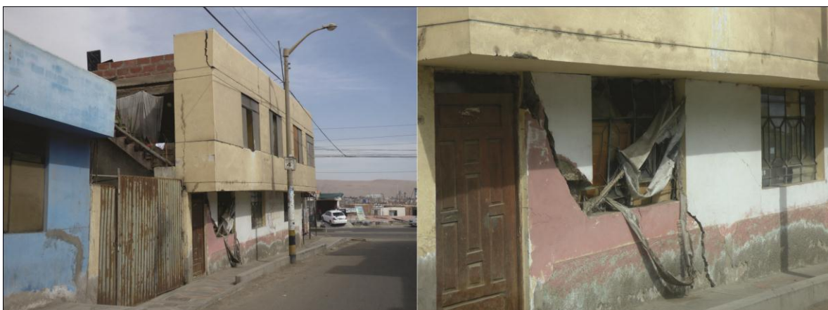
Foto 4. Viviendas de la Asociación de Vivienda La Florida afectada por el sismo del 2001, como se puede apreciar aún se aprecian los agrietamientos en las viviendas.
