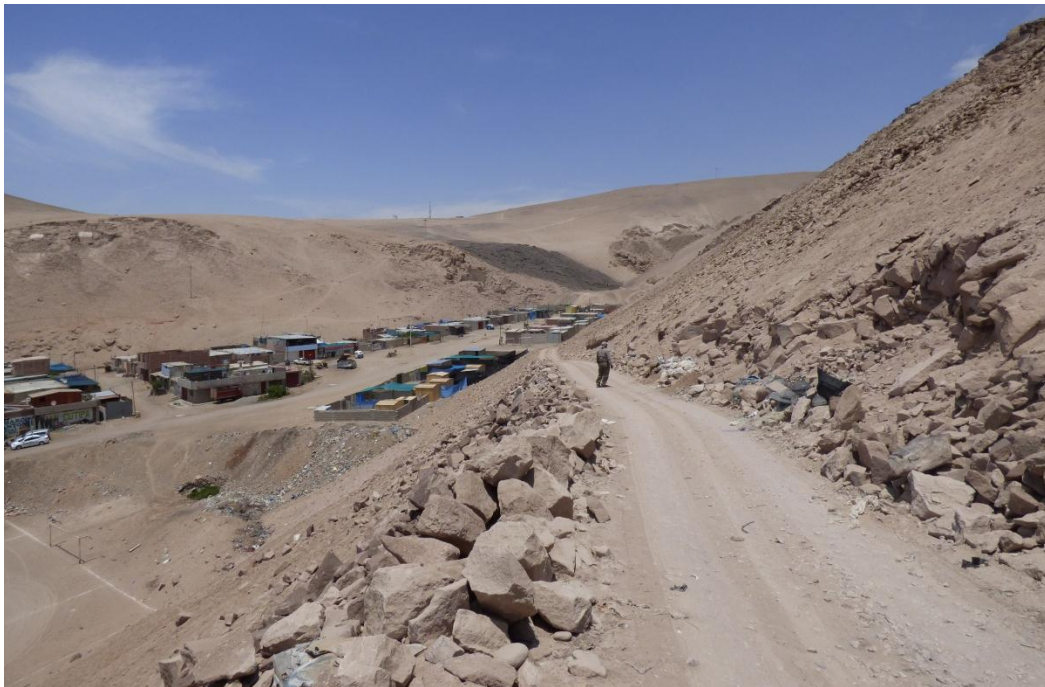
Foto 11. Derrumbe en forma de canchales de detritos en el talud natural y de corte en la trocha de acceso a la Asociación de Vivienda Villa Cristo de la Paz, margen izquierda de la quebrada del Diablo.
