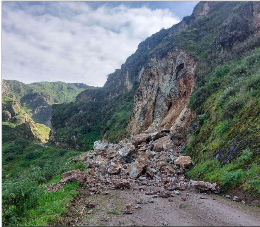
Figura 37. Vista panorámica de la zona crítica - Sector Marcapicche.
