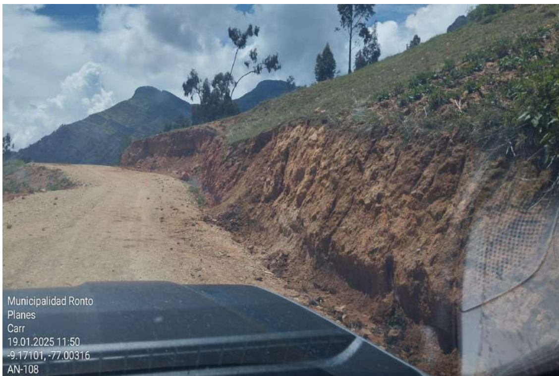
Zonas críticas, debido a que no se cuentan con presupuesto.
