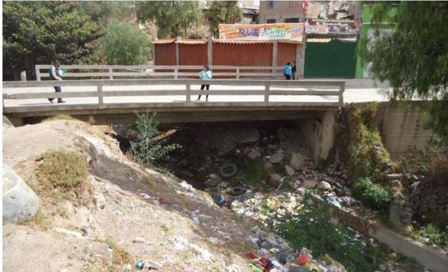
Foto 17. Quebrada Chaquiwayco, puente Las Américas, se observa muros de contención cubiertos por basura y escombros.
