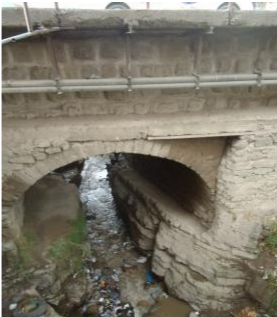
Foto 18. Se observa estrechamiento del cauce.
