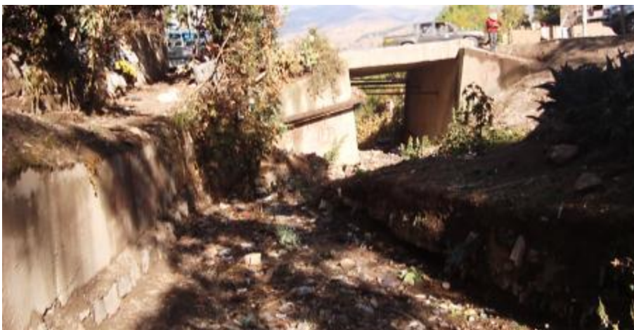
Foto 42. Vista de puente y muro de concreto de 1,5 m de altura, en los márgenes de la quebrada, vía Los Libertadores.
