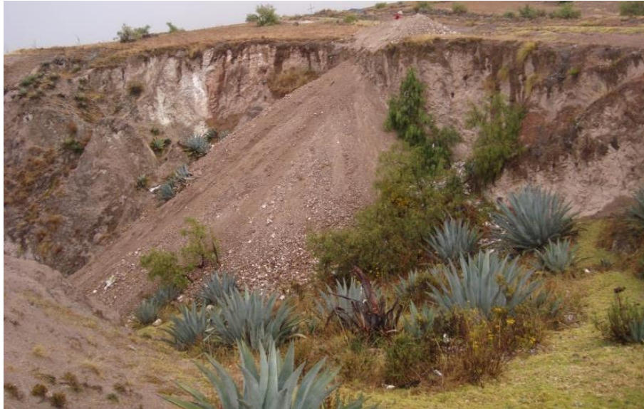
Foto 25. Se aprecia el material suelto vertido (desmonte) en el cauce de la quebrada.
