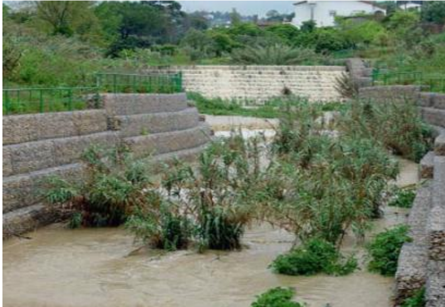
Foto 43. Vista de gaviones protegiendo las riberas de un río.
