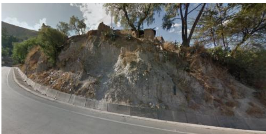
Foto 30. Corte de la Vía los Libertadores sobre la cual se ha edificado viviendas de material noble y adobe.
