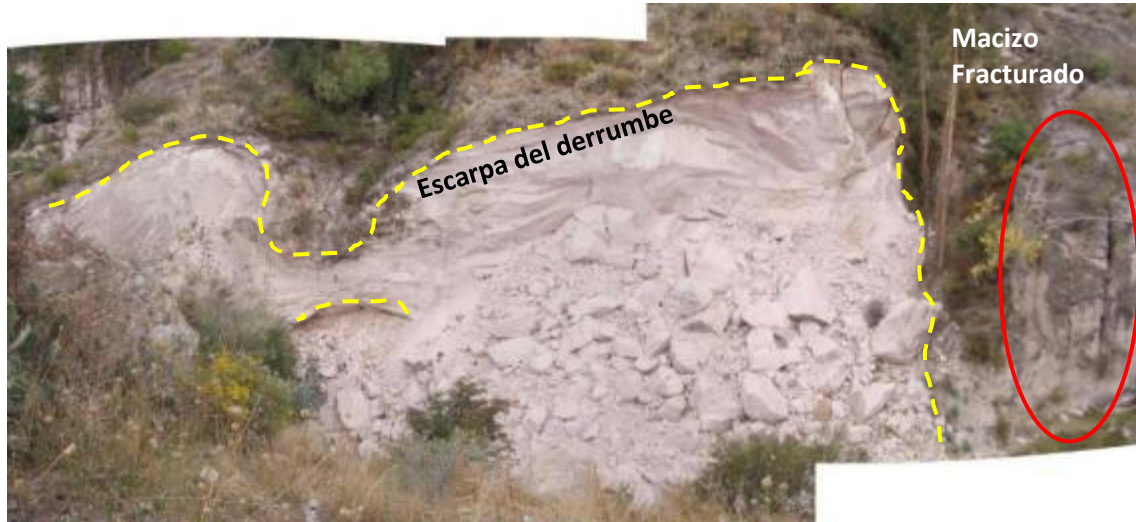
Foto 37. Sector Barranqueños, se muestra un derrumbe que obstruyó el cauce de la quebrada Chaquihuayco.
