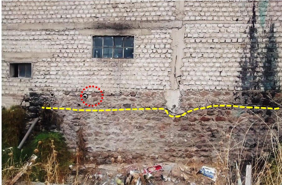
Foto 21. Vivienda con bases agrietadas, además presenta conexiones de desagüe hacia la quebrada.
