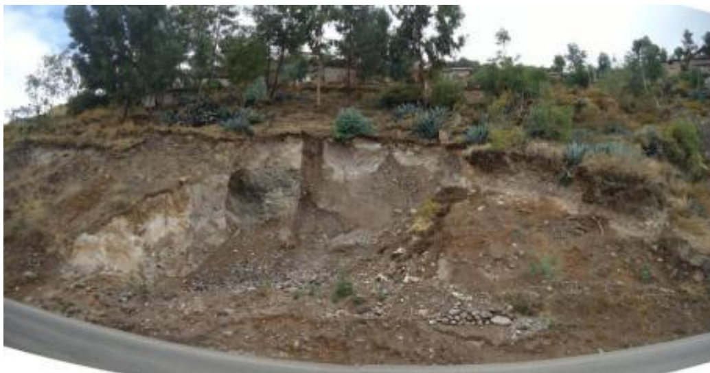
Foto 38. Derrumbes en los cortes de talud de carretera Los Libertadores.
