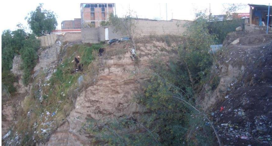
Foto 35. Vista desde el sector Pérez de Cuellar, se aprecia viviendas ubicadas en la cabecera de la cárcava.
