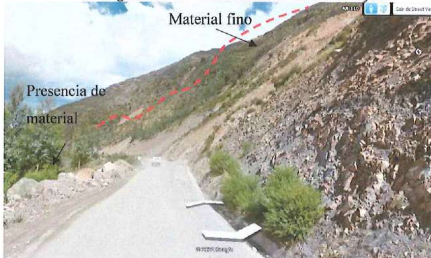
Fotografía N° 7. Deslizamiento en Jircahuayi 2
