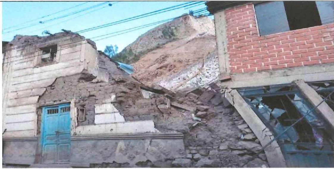
Viviendas Dañadas en Cerro Shallapa Chavín de Huántar ZC03MM
