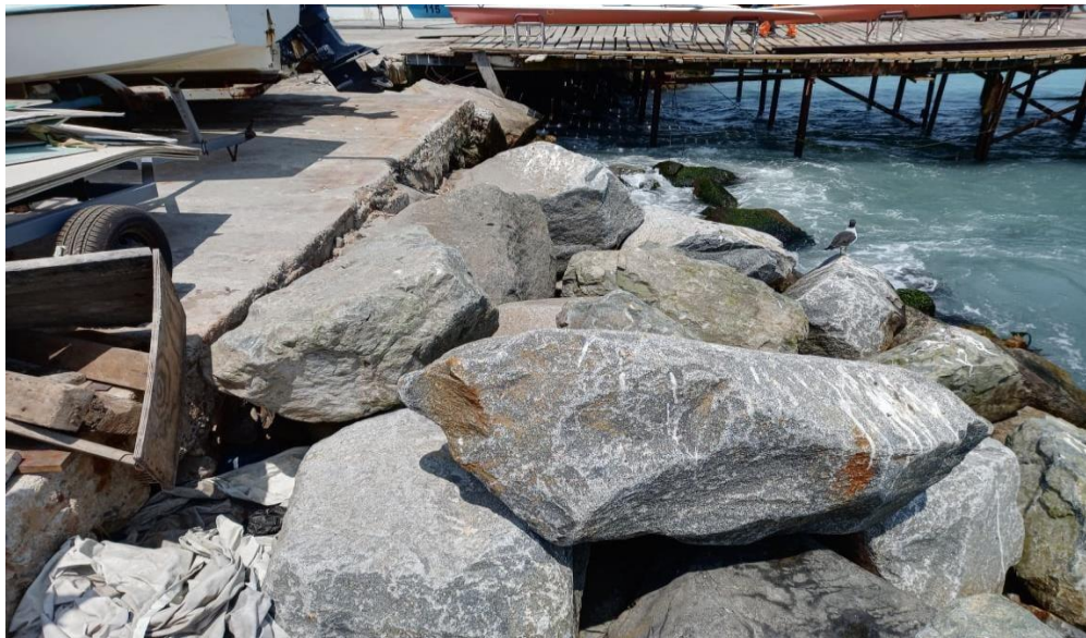
FIGURA 16: ZONA CRÍTICA 1 POR EROSIÓN DEBIDO A LOS OLEAJES ANÓMALOS
