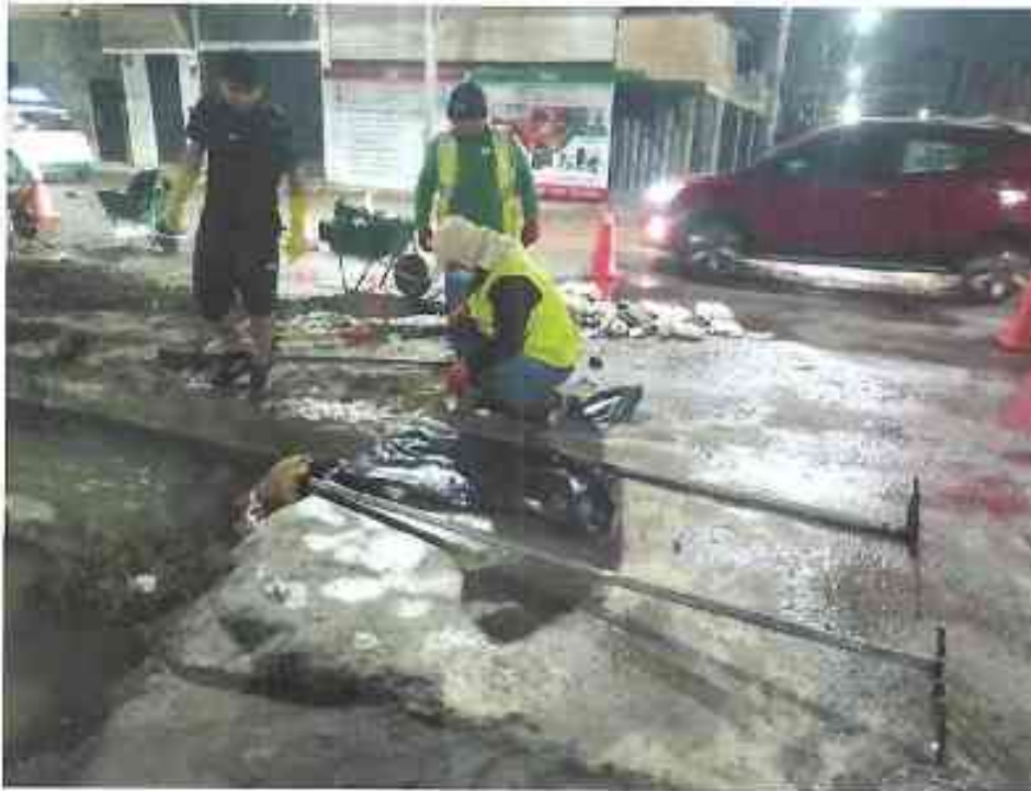
En la acequia Coiz, se han presentado colapsos y desbordes de la acequia debido a la acumulación de residuos sólidos.
