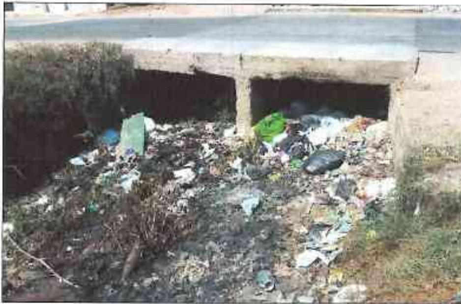
El canal Yortuque se ha identificado como sitio de acumulación de residuos. Fuente: Equipo Técnico.
