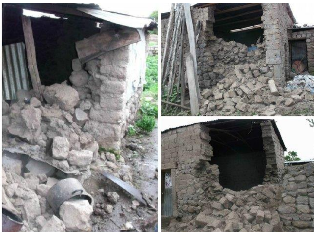
Figura 22: Daños en viviendas de adobe y piedras como efectos por la ocurrencia de sismos en el valle del Colca en el año 2013-
