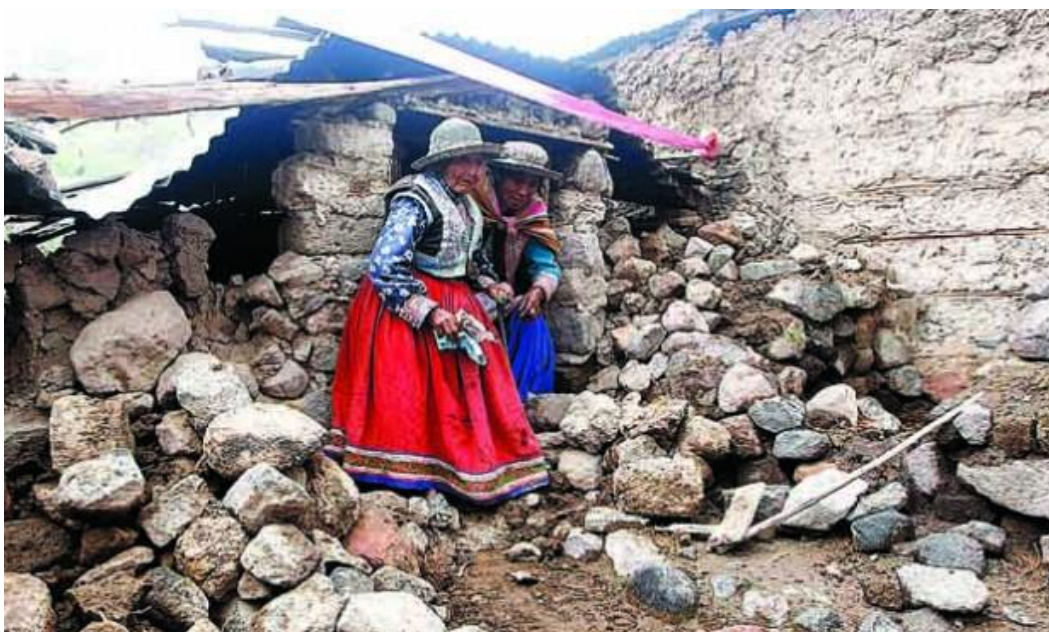
Figura 21: Daños en viviendas de adobe y piedras como efectos por la ocurrencia de sismos en el valle del Colca
