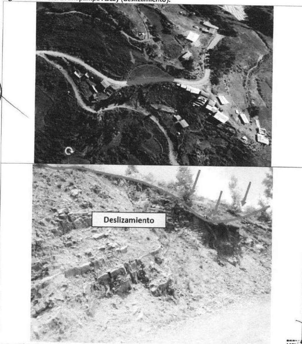
Figura 22. Carretera Amapampa-Ascay (deslizamiento).
