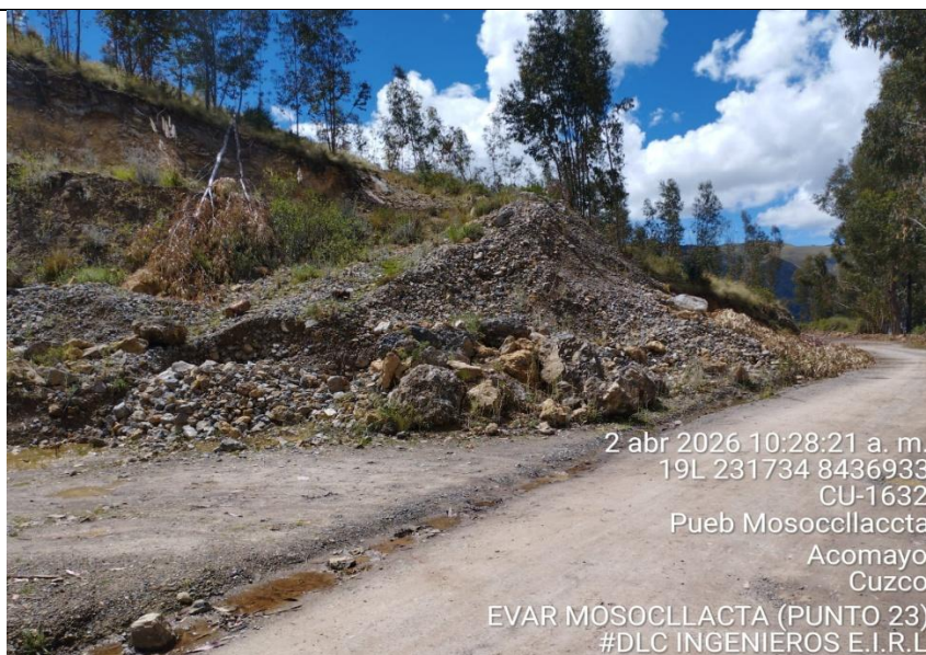
Foto 30 Vista del talud erosionado
