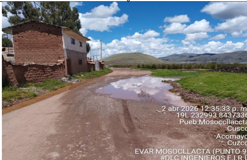
Foto 26 Vista del deterioro de la carretera en la progresiva 2+300
