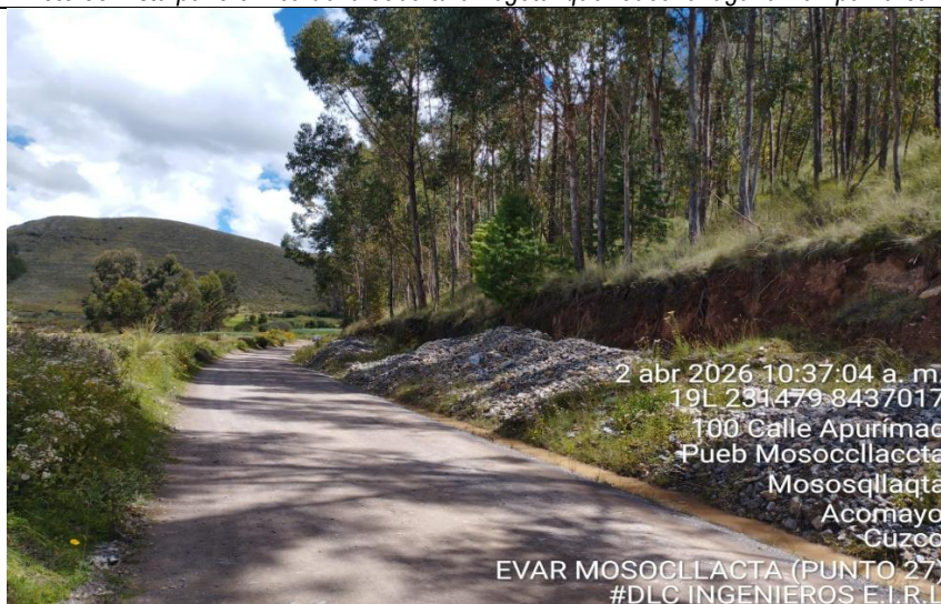
Foto 34 Vista del material acumulado al costado de la carretera
