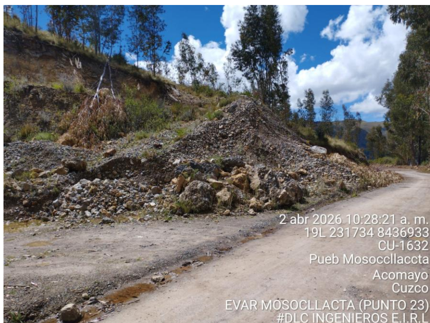
Foto 17 Progresiva 3+000, deslizamiento de material inestable afectando a la carretera
