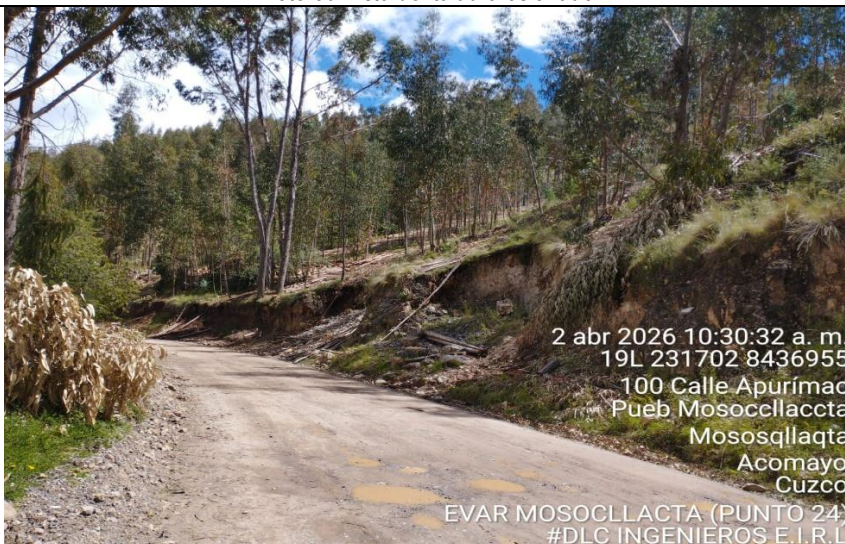
Foto 31 Vista del deterioro de la carretera en la progresiva 4+500
