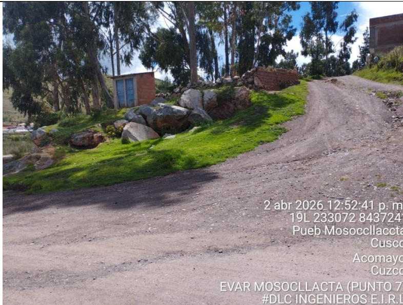
Foto 24 Vista de la degradación de la carretera
