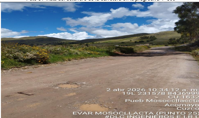
Foto 32 Vista del estado regular de la carretera
