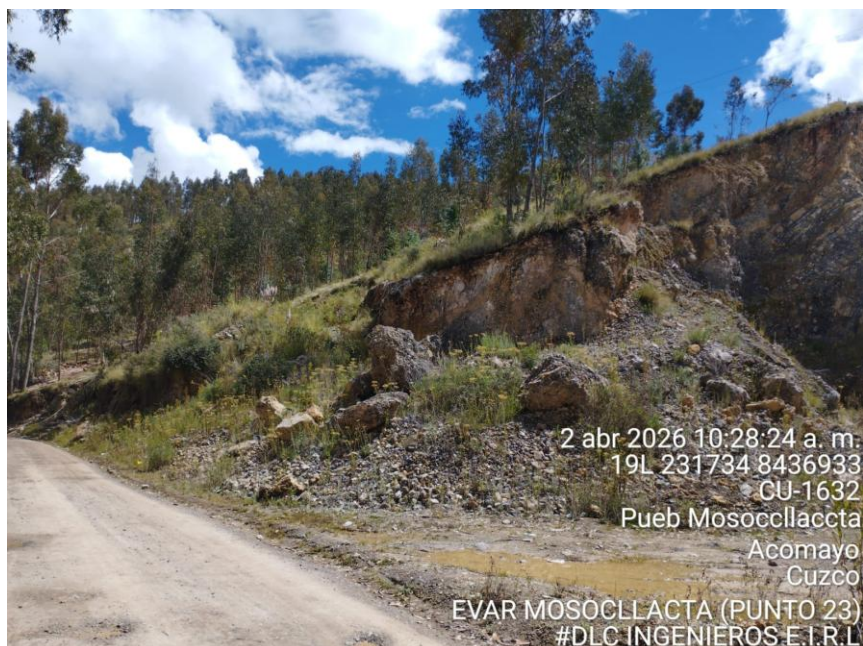
Foto 16 Progresiva 2+800, deslizamiento de material inestable en la margen derecha de la carretera
