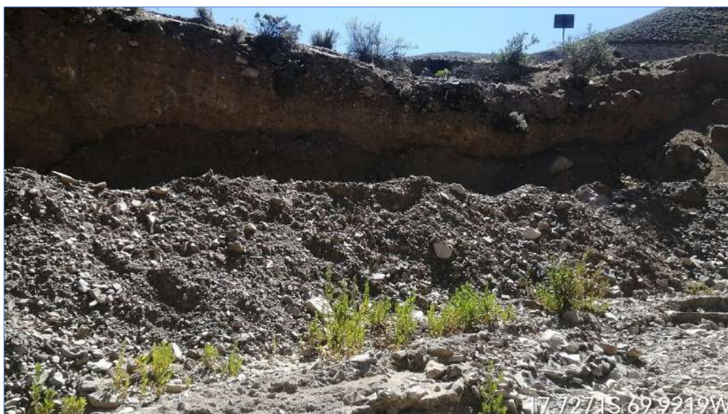
Fotografía 2 – Vista de cauce de Qda Ataspaca, se observa socavación en los laterales
