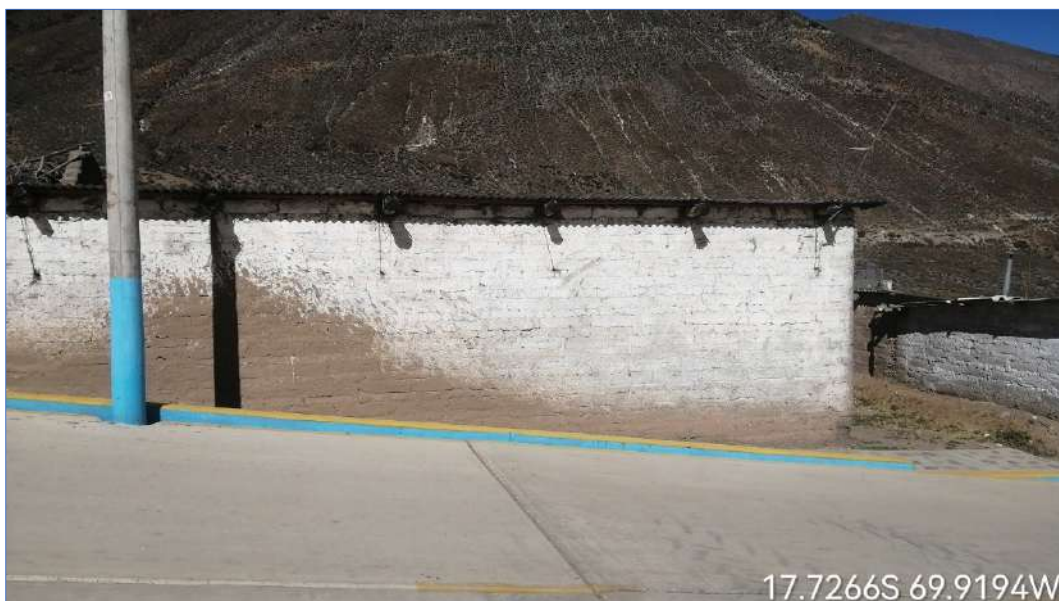
Fotografía 21 – Vista de viviendas del CP Ataspaca, se observa huella del ingreso del huaico del 4 de febrero del 2019
