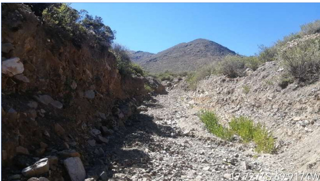
Fotografía 10 – Vista de cauce de Qda Ataspaca, se observa socavación
