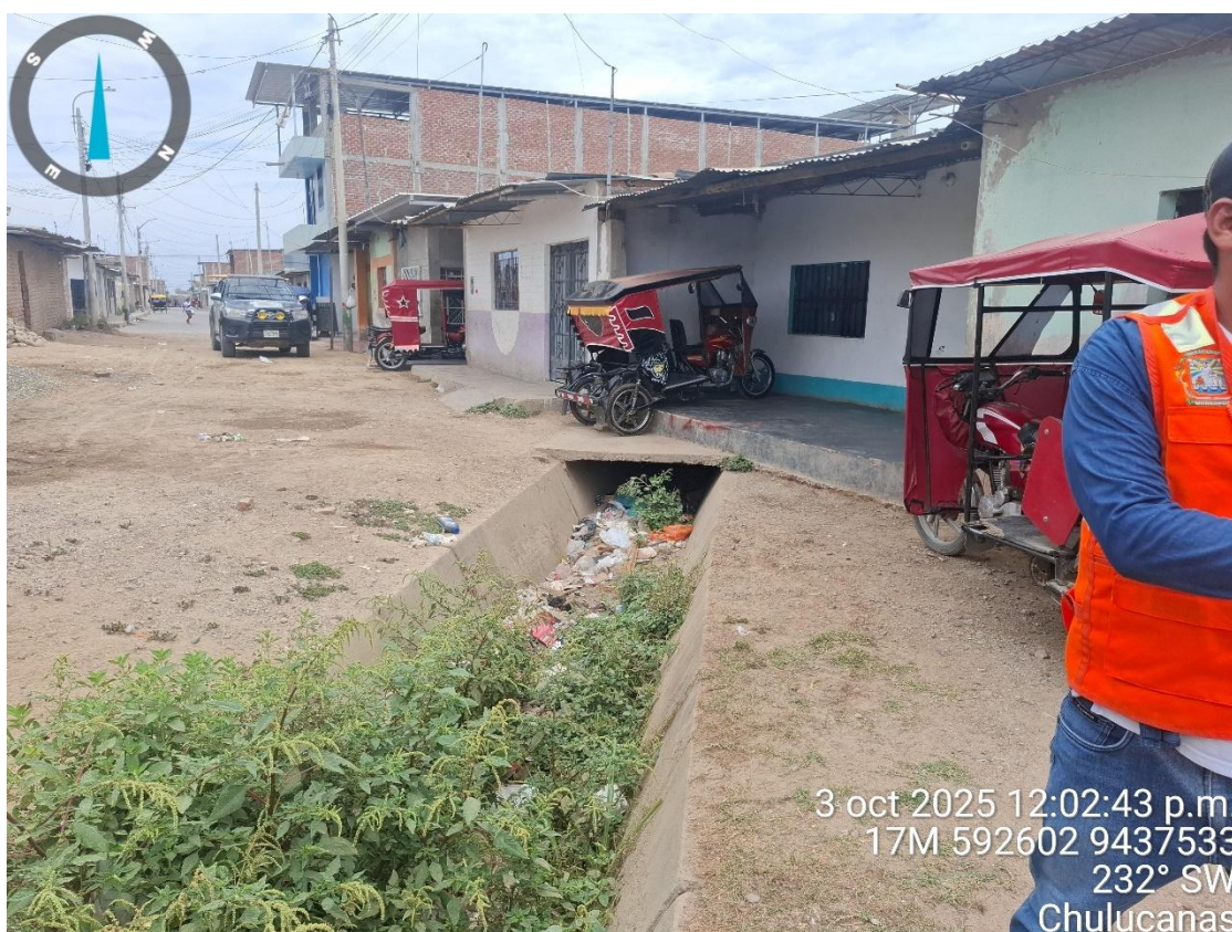
FIGURA 14. VIVIENDAS DEL SECTOR PILAR NORES ASENTADAS SOBRE CANAL DE IRRIGACIÓN QUE DIFICULTAN LAS ACTIVIDADES DE LIMPIEZA Y MANTENIMIENTO
