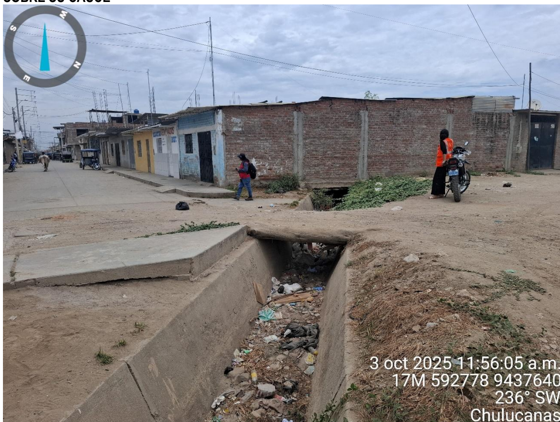
FIGURA 13. CANAL HIDALGO COLMATADO AGUAS ABAJO DEL ÁREA DE ESTUDIO CON BASURA Y DESMONTES DEBIDO A LA DIFICULTAD DE LIMPIEZA POR UBICACIÓN DE VIVIENDAS SOBRE SU CAUCE
