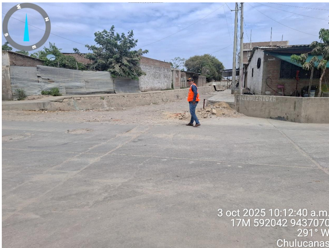
FIGURA 13. INTERSECCIÓN DE CALLES MARÍA AUXILIADORA Y LIBERTAD, DONDE INICIA CANAL DE MAMPOSTERÍA (1.20 m DE PROFUNDIDAD) EN REGULAR ESTADO DE CONSERVACIÓN QUE SE ENCEUNTRA PARCIALMENTE COLMATADO CON BASURA Y DESMONTE QUE DRENA LAS AGUAS PRUVIALES DEL MERCADO MUNICIPAL
