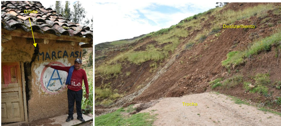
Figura 30. A: Grieta en vivienda situada a casi 200 m del límite del cuerpo del deslizamiento. B: Troca carrozable que une Sisco con los pueblos de Rancas y Ocros, destruido por el deslizamiento.
