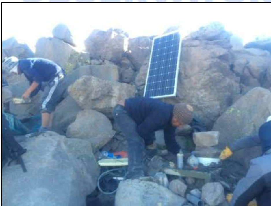
Figura 2.3. Construcción de la caseta de seguridad para la estación telemétrica SAB07, ubicada en el flanco SE.
