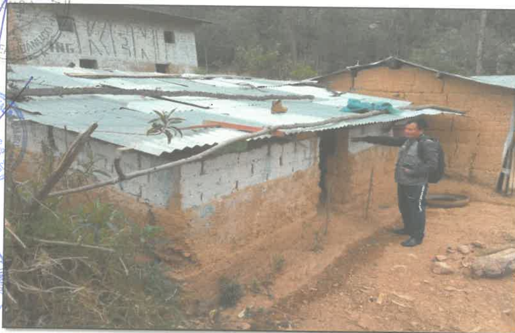
Vista N° 01: Se observa que las viviendas se encuentran expuestas al peligro de deslizamientos; la información ha sido registrada en la Ficha Técnica N°-01.
