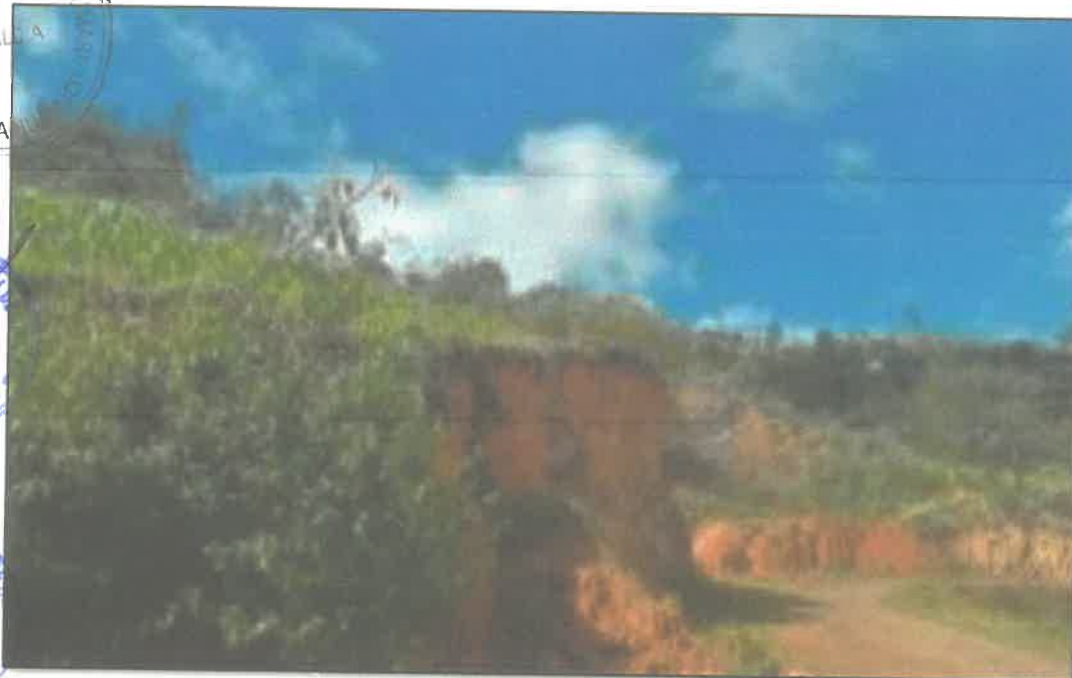
Vista N° 05: Se observa que las vías vecinales se encuentran expuestas al peligro de deslizamientos; la información ha sido registrada en la Ficha Técnica N°-03.
