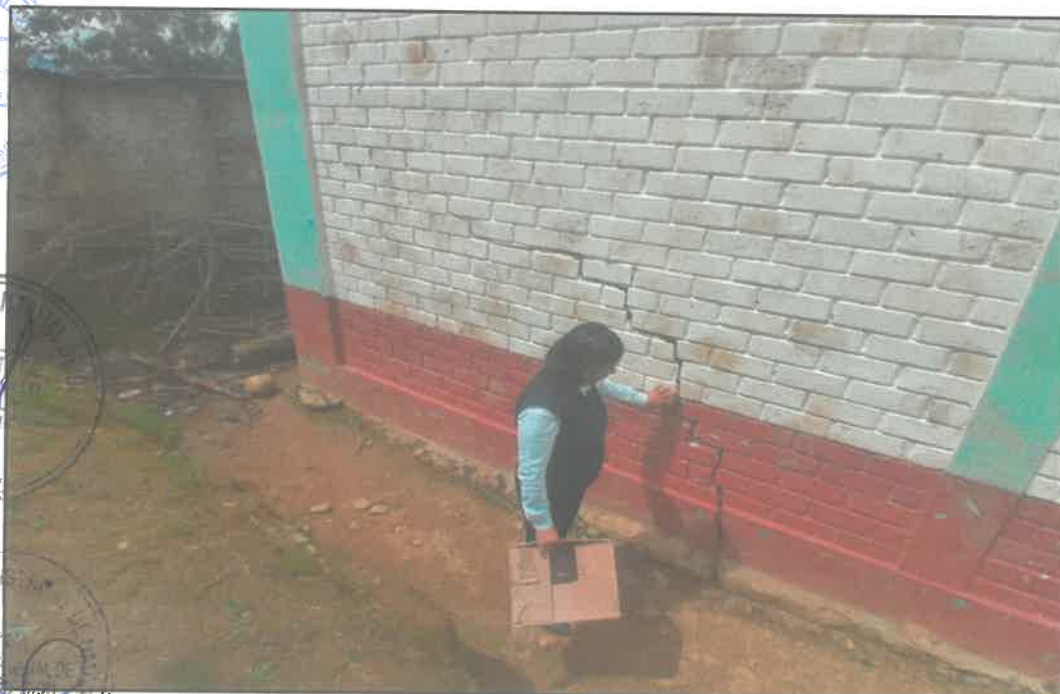
Vista N° 16: Se observa que las viviendas colindantes se encuentran expuestas al peligro de deslizamientos; la información ha sido registrada en la Ficha Técnica N°-12.
