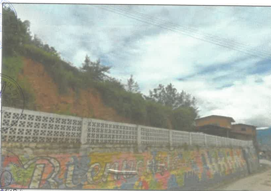
Vista N° 04: Se observa que las viviendas colindantes se encuentran expuestas al peligro de deslizamientos; la información ha sido registrada en la Ficha Técnica N°-02.
