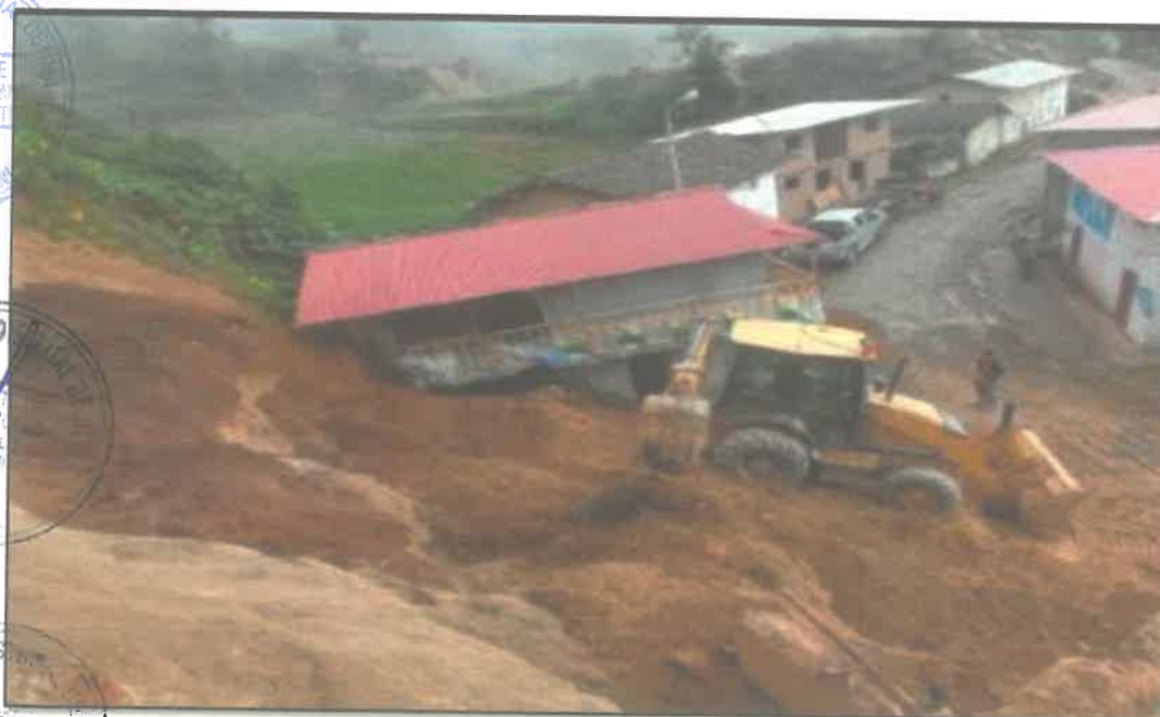
Vista N° 06: Se observa un deslizamiento afectando viviendas y vías y así como sus medios de vida; la información ha sido registrada en la Ficha Técnica N°-04.
