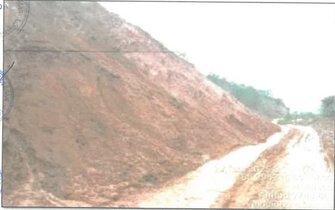
Vista N° 11: Se observa que la afectación de vías vecinales a causa de deslizamiento de la pendiente de tierra; la información ha sido registrada en la Ficha Técnica N°-08.
