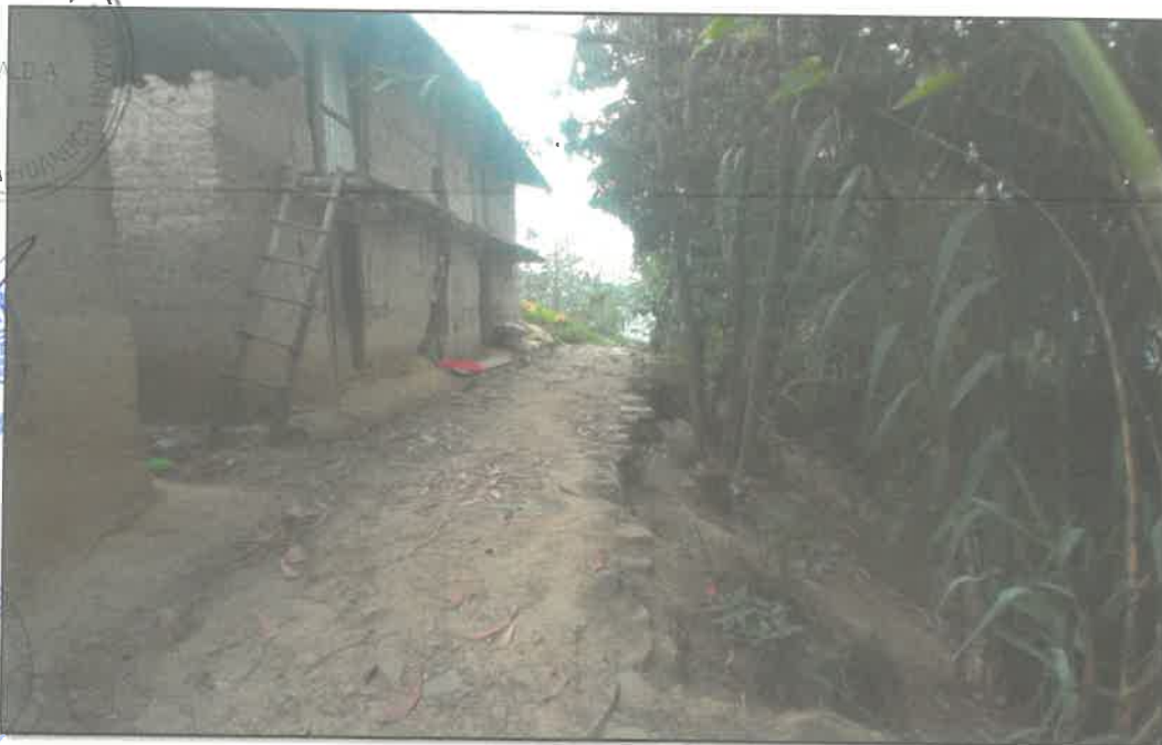
Vista N° 03: Se observa que las viviendas se encuentran expuestas al peligro de deslizamientos; la información ha sido registrada en la Ficha Técnica N°-01.
