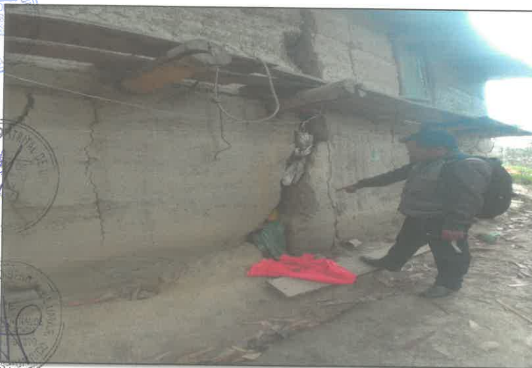
Vista N° 02: Se observa que las viviendas se encuentran expuestas al peligro de deslizamientos; la información ha sido registrada en la Ficha Técnica N°-01.
