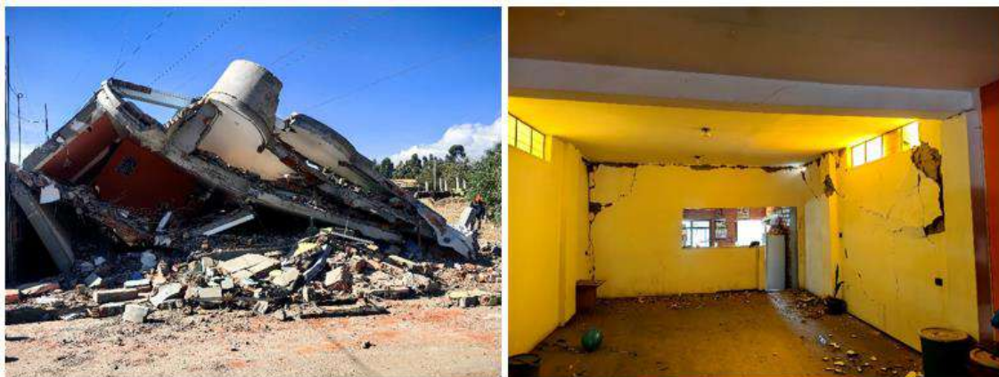
Figura 37.- Izquierda: Edificación de 4 niveles con daño severo recientemente demolido por la Municipalidad de Huancayo. Derecha: Vista interior de edificación de 3 niveles con daño severo en los muros portantes.
