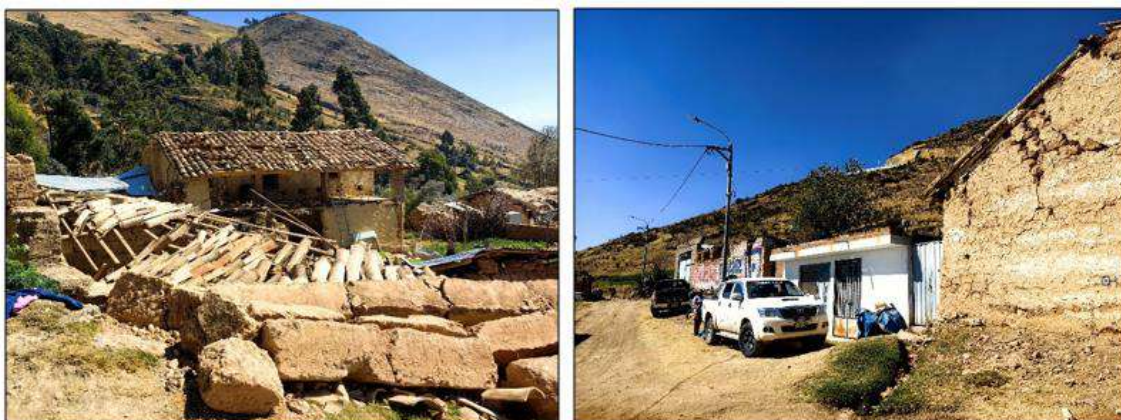
Figura 33.- Viviendas de adobe dañadas y la única de albañilería sin daños
