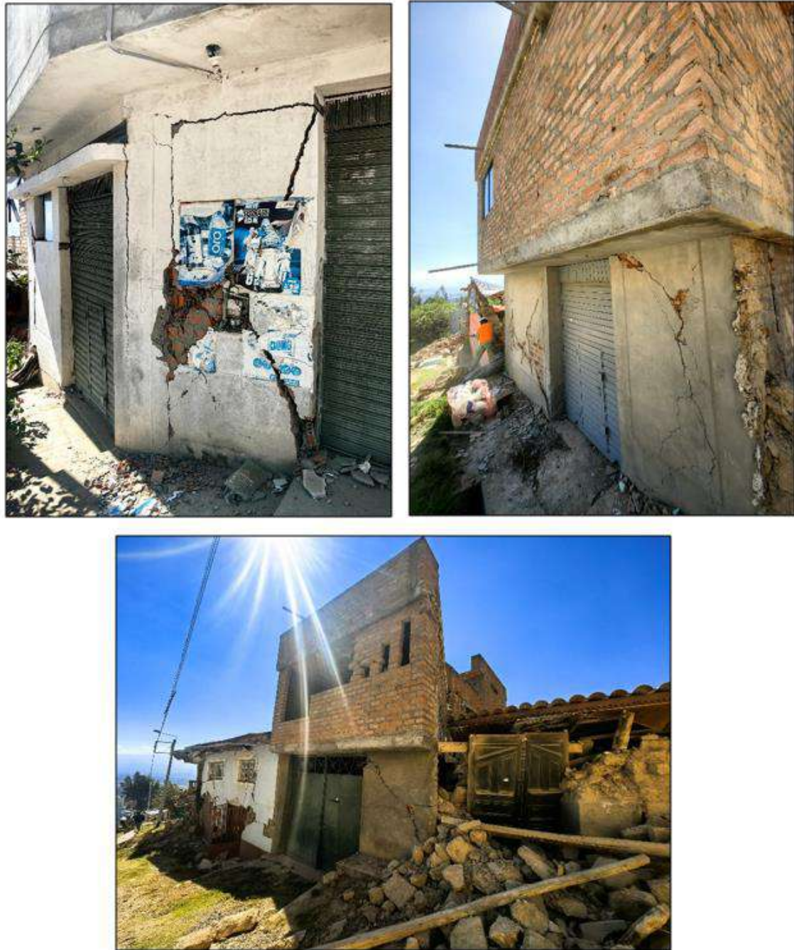
Figura 31.- Viviendas de albañilería con daños estructurales.
