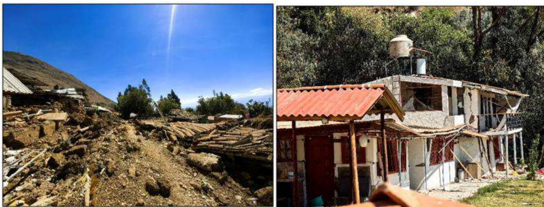
Figura 32.- Viviendas de adobe desplomadas y de albañilería muy dañada
