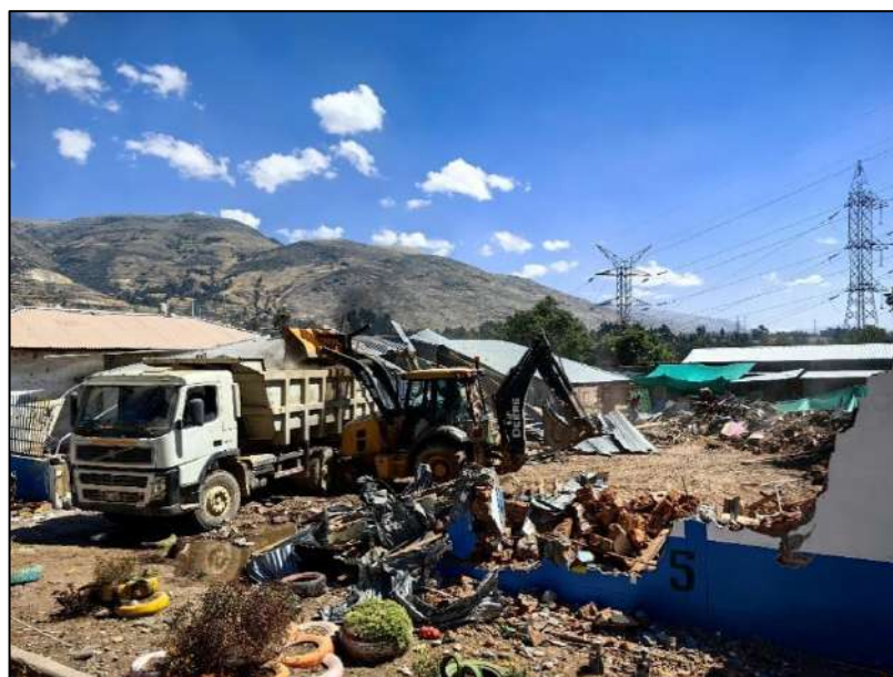
Figura 36.- Restos de la I.E. 593 Miraflores tras su demolición preventiva por la Municipalidad Provincial de Huancayo
