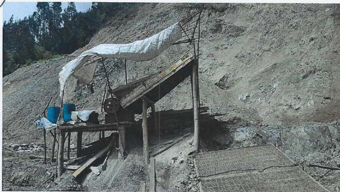
Fotografía N° 4: Verificación de sectores críticos por movimientos en masa y debilitamiento de taludes por extracción de cantera en localidad de Orccomayo, distrito de Talavera.
