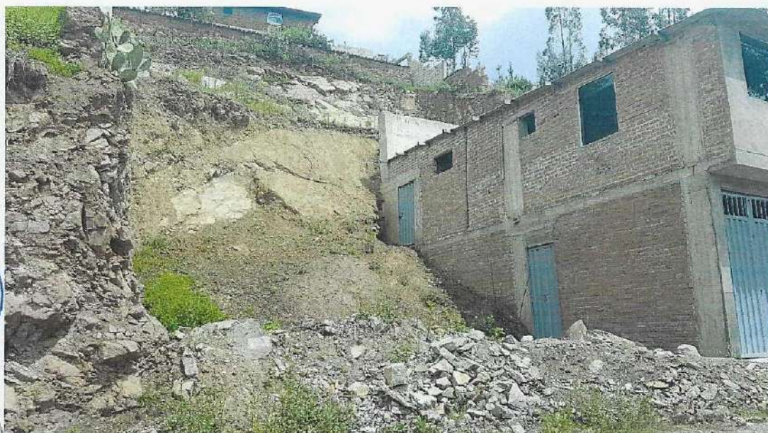
Fotografía N° 1: Verificación de sectores críticos y elementos expuestos (viviendas), en sector de Aranjuez, distrito de Talavera.
