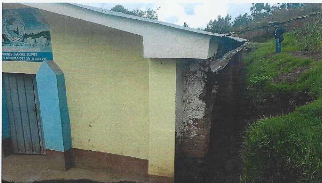
Fotografía N° 3: Verificación de sectores críticos por movimientos en masa y elementos expuestos (viviendas), en localidad de San Antonio de Huarataca, distrito de Talavera.
