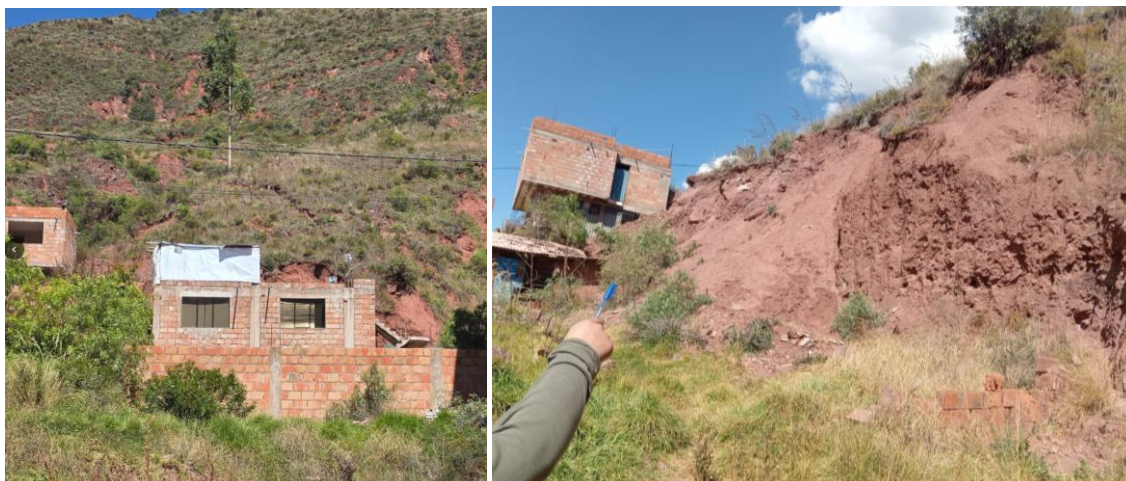
FOTOGRAFÍA 28: LOTES Mz. C, D DE LA APV. MOLLEMOLLEYOC UBICADO EN LA PARTE BAJA DE UN DESLIZAMIENTO.
