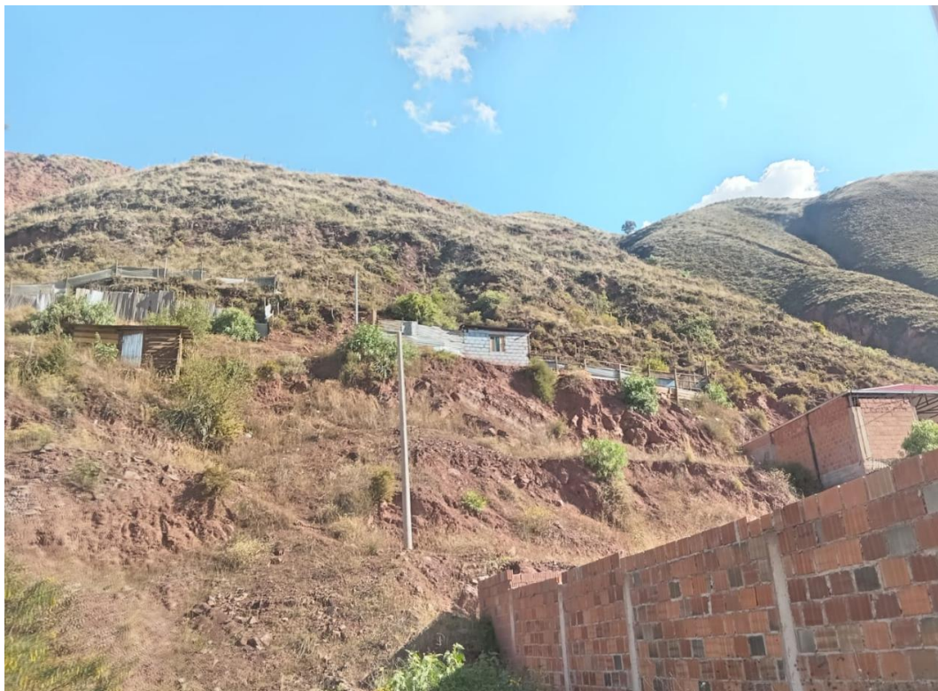
FOTOGRAFÍA 30: CORTES DE TALUD SIN NINGUNA OBRA DE SOSTENIMIENTO – Mz H, I DE LA APV MOLLEMOLLEYC.
