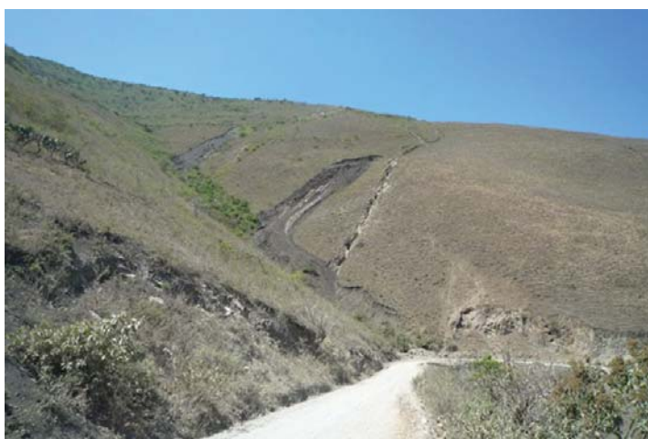
Fotografía 6.41 Tramos de la carretera de acceso a Ayabaca, afectados por deslizamientos, erosión de laderas y flujos de detritos
