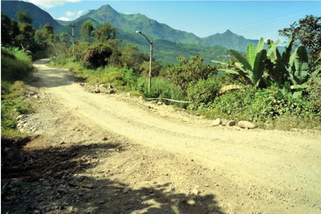
Fotografía 6.24 Sector de Huallanay, movimiento en masa antiguo reactivado por sectores a manera de reptación de suelos, produce asentamientos en la carretera Huancabamba-Charanal. Distrito de San Miguel de El Faique, provincia de Huancabamba
