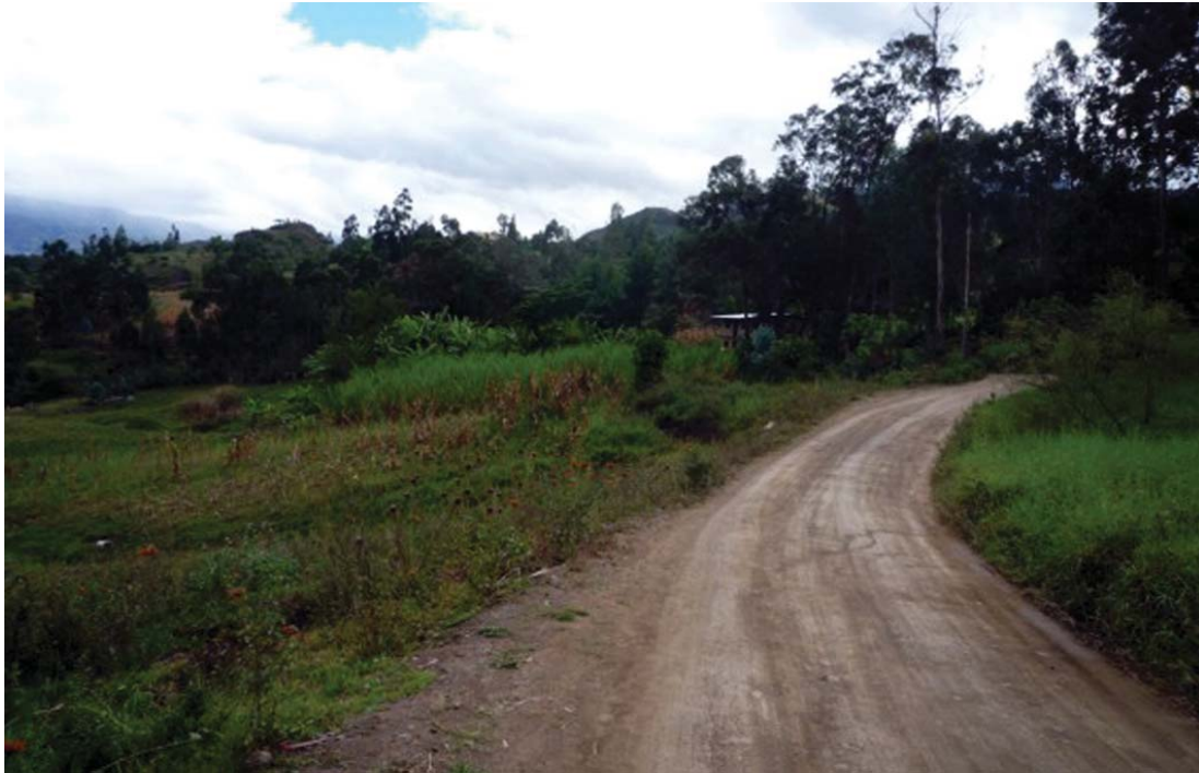
Fotografía 6.20 Km 07+000 de la carretera Huancabamba-Sondor (Quebrada Pucutay), la plataforma se encuentra asentada y ondulada por el movimiento del terreno. Distrito de Sondor, provincia de Huancabamba
