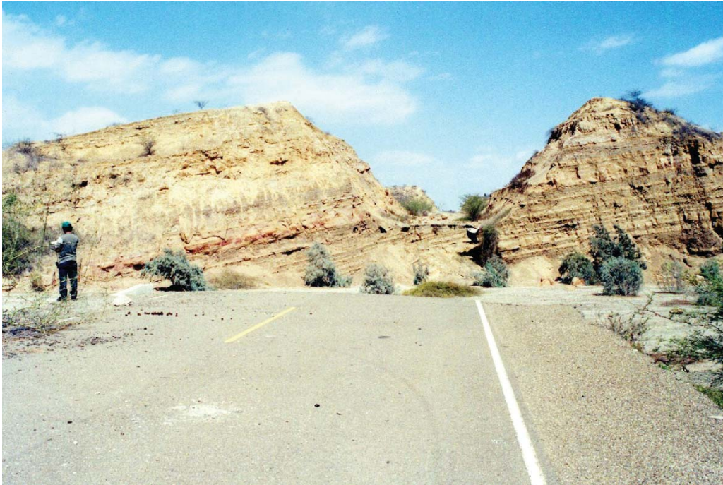
Fotografía 6.77 Panamericana Norte entre el km 1067 al km 1075, por los flujos de lodo que discurren por las quebradas de forma excepcional durante el Fenómeno El Niño. Se ha tenido que realizar variantes en el trazo de la carretera.
