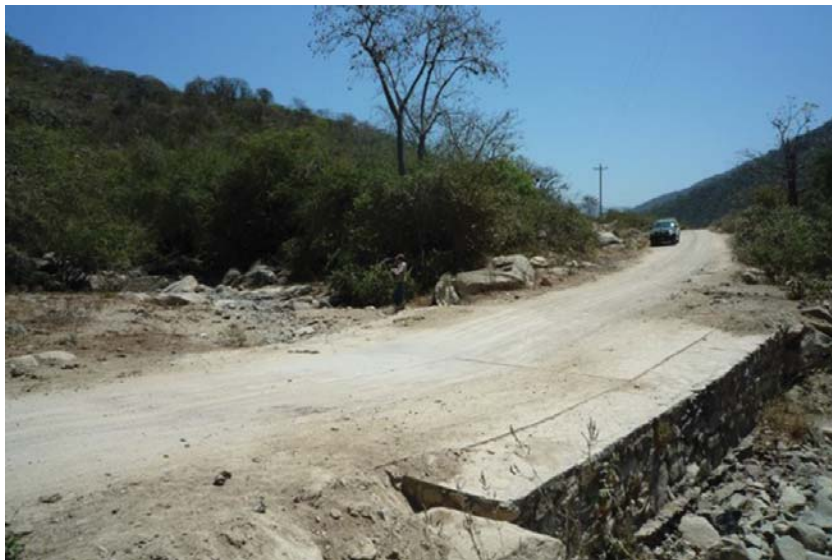
Fotografía 6.62 Carretera Chipillico-Sapillica, cortado por flujos de detritos
