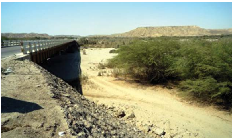
Fotografía 6.15 Quebrada Pariñas, por donde discurren flujos de manera excepcional, el Flujo puede erosionar estribos del puente. A la entrada del puente se ha colocado diques para controlar la erosión. Distrito de Pariñas, provincia de Talara
