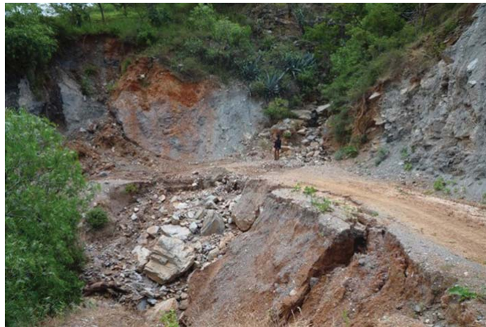
Fotografía 6.47 Tramo de la carretera Sondorillo-Huarmaca, cortado totalmente por la erosión en cárcavas intenso
