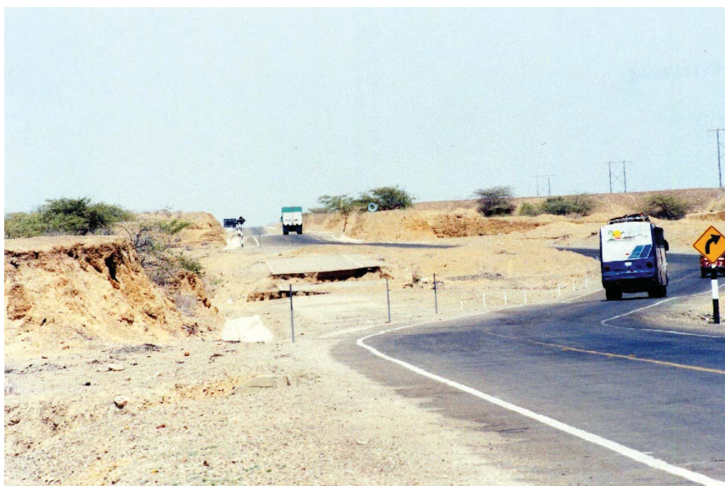
Fotografía 6.86 Panamericana Norte entre el km 1046 al km 1058, con tramos destruidos por los flujos de lodo que se producen durante el fenómeno El Niño
