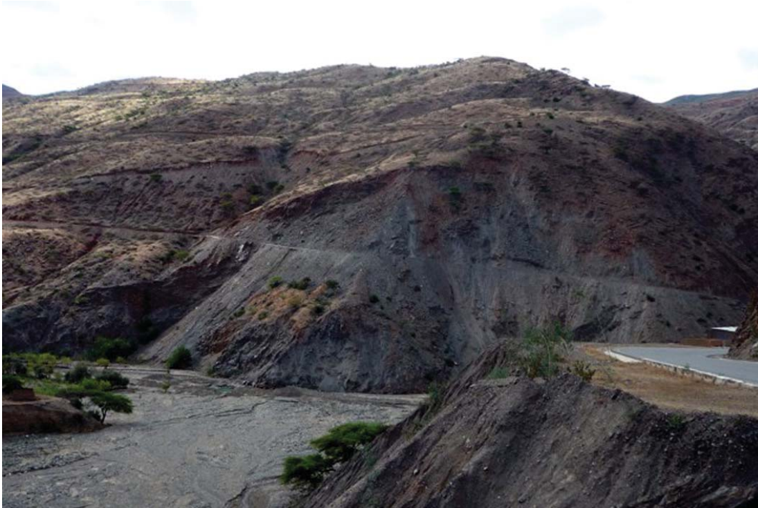
Fotografía 6.3 Derrumbes en carretera Nuevo Hualapampa-Huamaca a la altura del km 46+400 y el puente Huancabamba, región Piura
