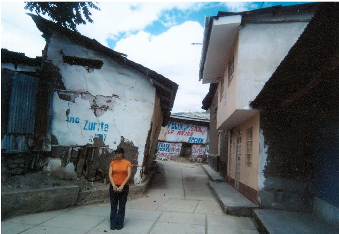
Fotografía 6.21 Ciudad de Huancabamba, afectado por flujo de tierra activo, el cual produce agrietamiento e inclinación de las paredes de las viviendas, también deformación y asentamientos en las pistas
