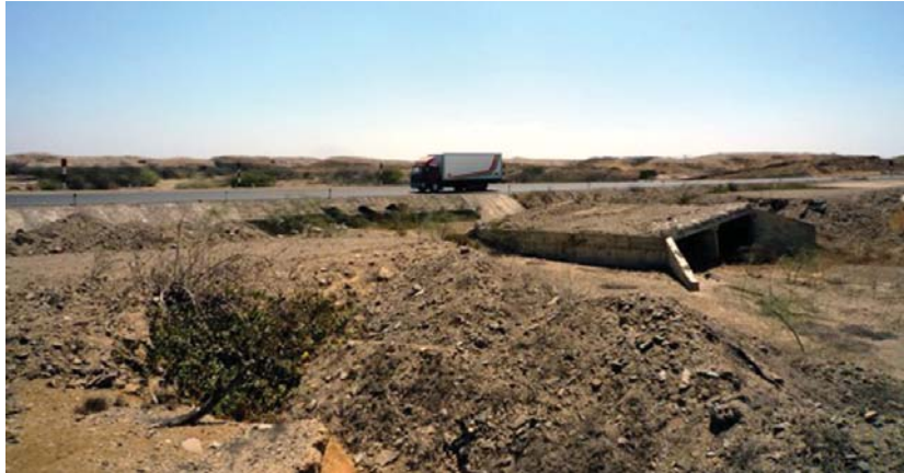
Fotografía 6.13 Km 65+00 de la carretera Sullana-Talara, donde se genera un Flujo de detritos excepcional que discurre por el tributario de la quebrada Ancha, actualmente seca; destruyó 2 veces un tramo de la carretera Sullana-Talara y la alcantarilla, La Brea, Talara
