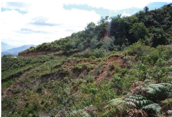
Fotografía 6.42 Carretera que conduce hacia el sitio arqueológico de Aypate, en el cerro Balcán, afectado por un deslizamiento activo que compromete tramo de carretera
