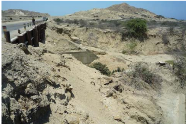
Fotografía 6.73 Carretera Talara-Negritos, cortada en varios sectores por torrenteras que se activan excepcionalmente
