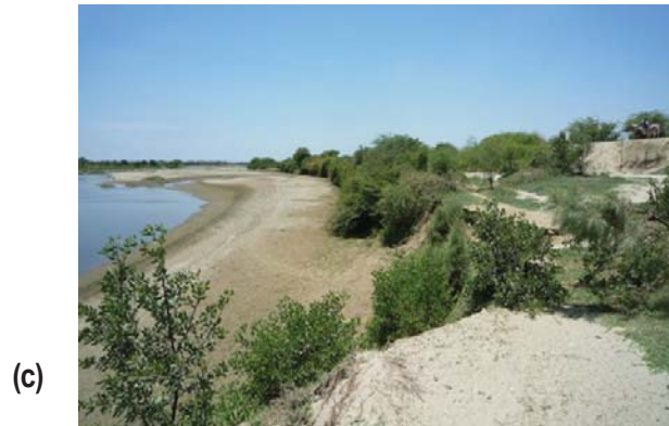
Fotografías 6.57 a, b y c Río Piura Aguas abajo del puente Independencia, ha producido erosión fluvial, afectó dique de encauzamiento
