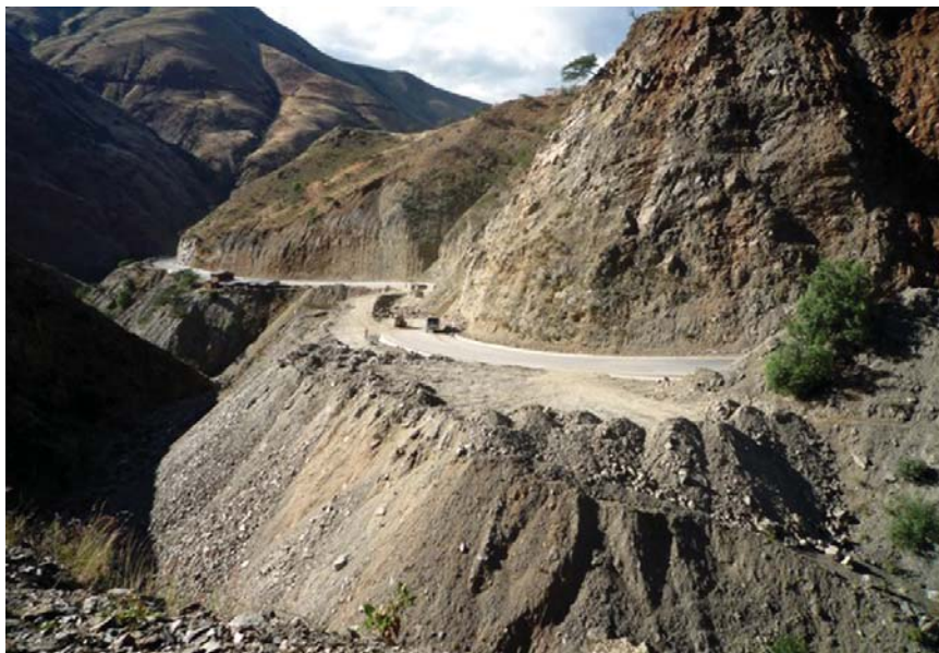
Fotografía 6.5 Derrumbes en carretera asfaltada Olmos-Jaén, a la altura del km 55+200, región Piura
