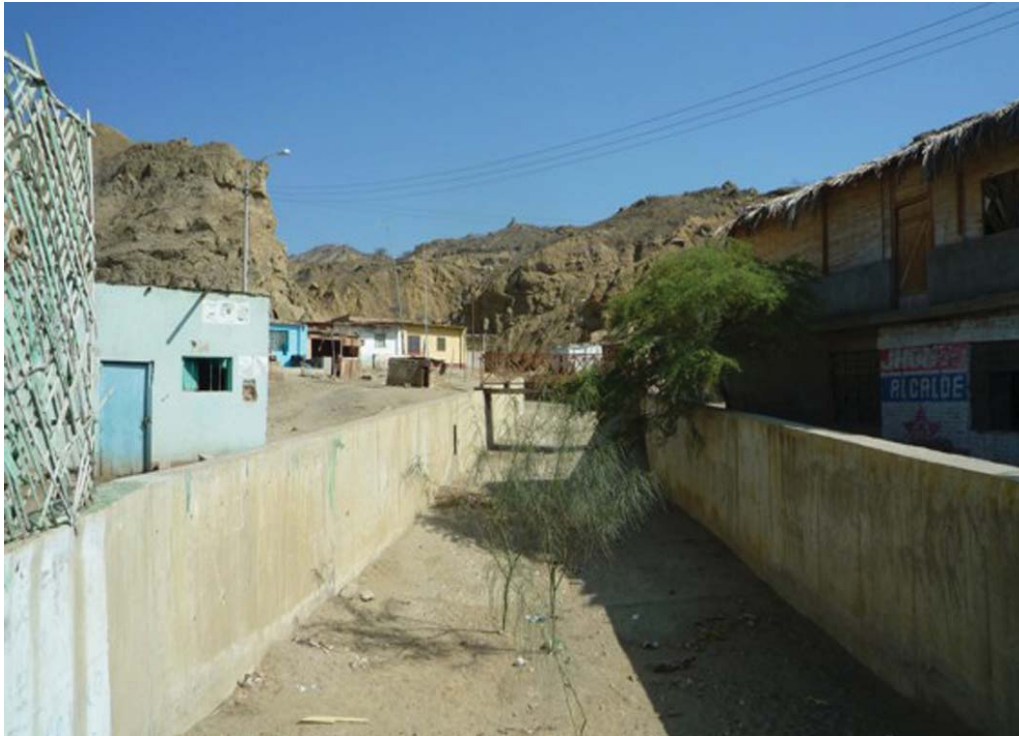
Fotografía 6.67 Torrenteras encauzadas en el sector de Cabo Blanco. Las viviendas se ubican muy cerca de los cauces.
