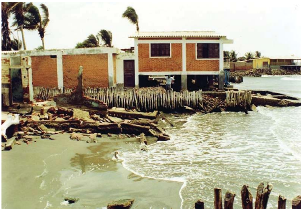
Fotografía 6.51 Procesos de erosión marina que afecta viviendas en La Esmeralda del distrito de Colán, provincia de Paita
