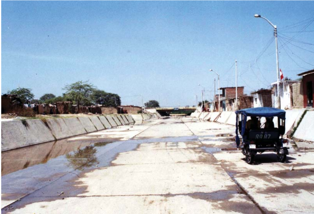
Fotografía 6.29 Canal-vía en Sullana, construido para evitar inundaciones en la ciudad con las lluvias excepcionales del fenómeno de El Niño. Distrito de Sullana, provincia de Piura
