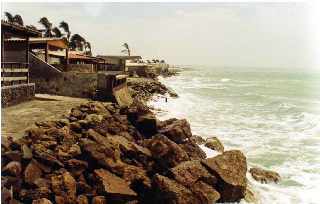
Fotografía 6.31 Erosión marina en la playa La Esmeralda de Colán, distrito de Colán, provincia de Paita. Afecta viviendas ubicadas muy cerca de la línea de costa; se han colocado enrocados para proteger las viviendas
