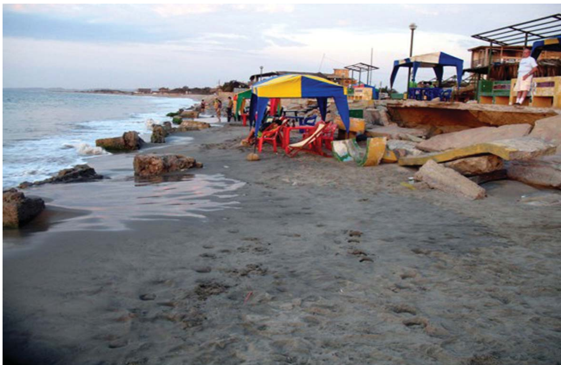
Fotografía 6.32 Erosión marina en el malecón de Máncora, ha destruido estructuras de concreto, provincia de Talara.
