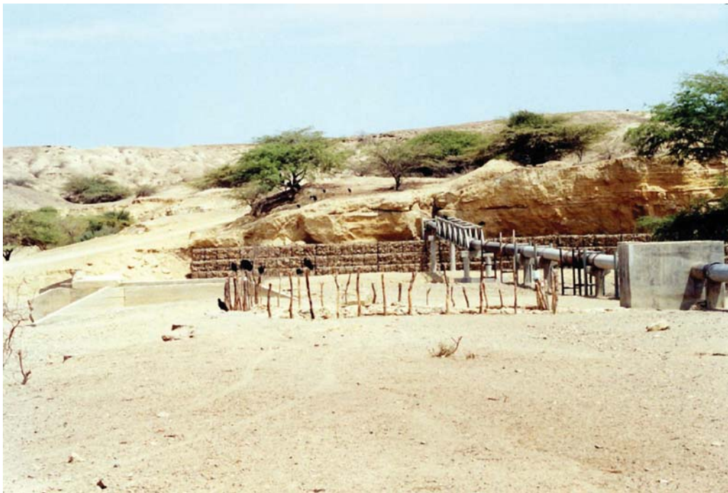
Fotografía 6.78 Tramo de la antigua carretera Amotape – Talara, la cual ha sido totalmente destruida por flujos de lodo y huaycos que se generaron durante los fenómenos El Niño. Sobre la quebrada Billar se han colocado gaviones para contener la erosión en su margen derecha y proteger la tubería de agua potable que va a Talara
