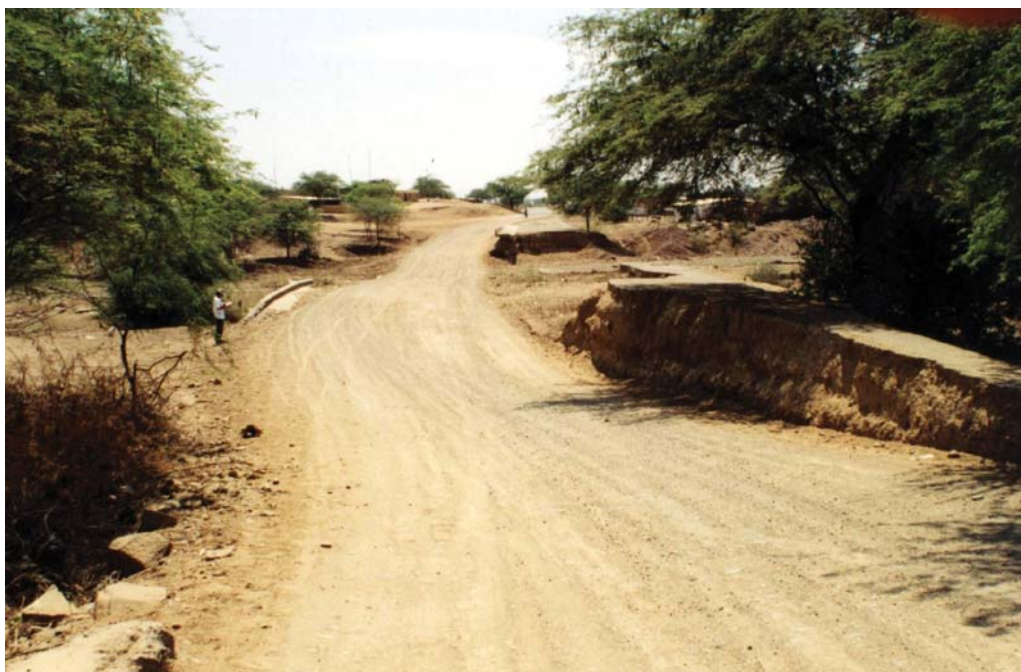
Fotografía 6.85 Carretera Sullana – Lancones afectada por flujos de lodo y huaicos en varios tramos, donde se ha perdido la plataforma asfaltada y las alcantarilladas. Se han tenido que realizar variantes
