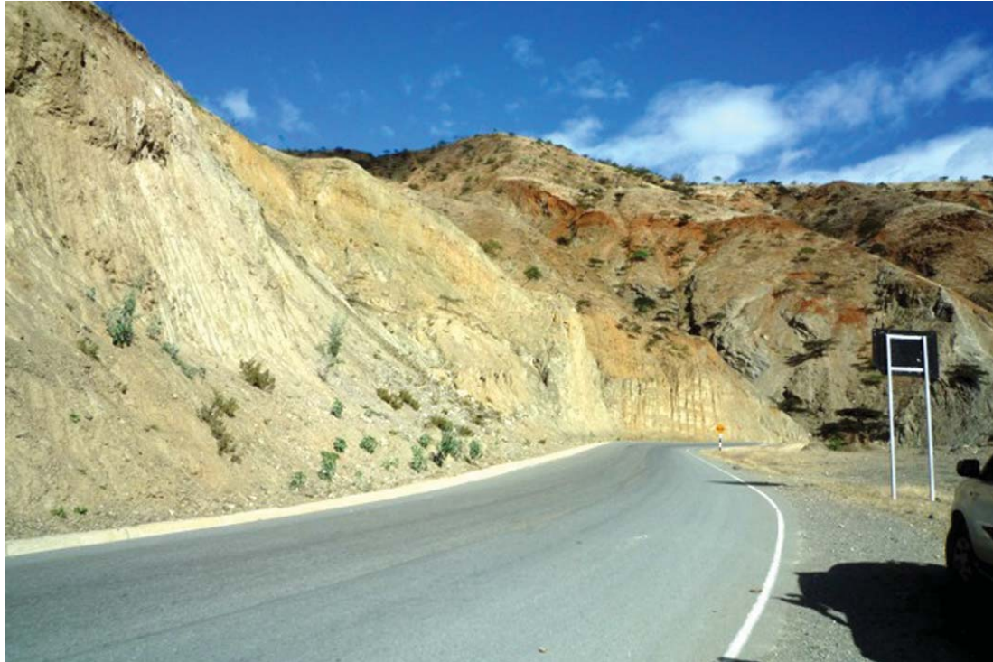
Fotografía 6.4 Derrumbes en carretera asfaltada Olmos-Jaén, a la altura del km 56+620, región Piura
