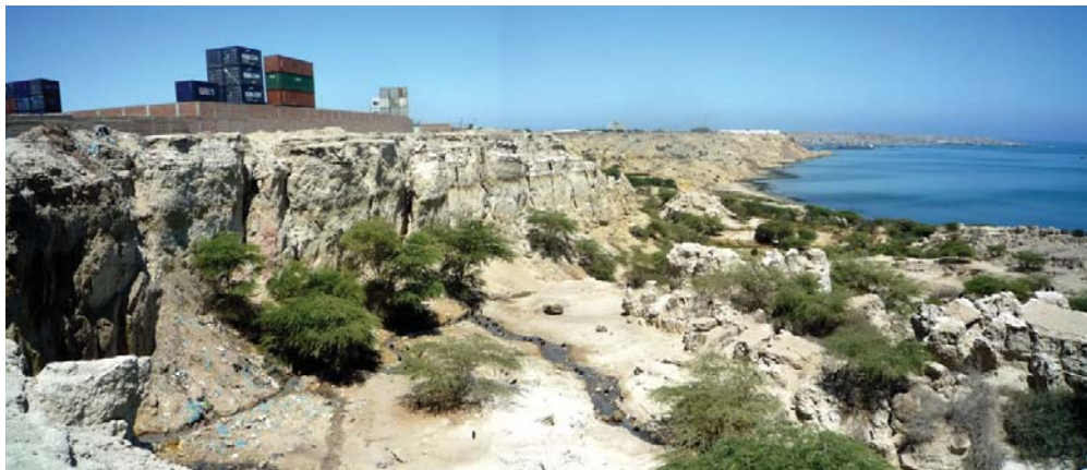
Fotografía 6.7 Distrito de Paita, cerca de Punta Cuñus; deslizamiento rotacional en acantilado de Paita, detrás de las fábricas de harina y conservas de pescado (La Molinera), presenta asentamiento en la cabeza del deslizamiento; región Piura
