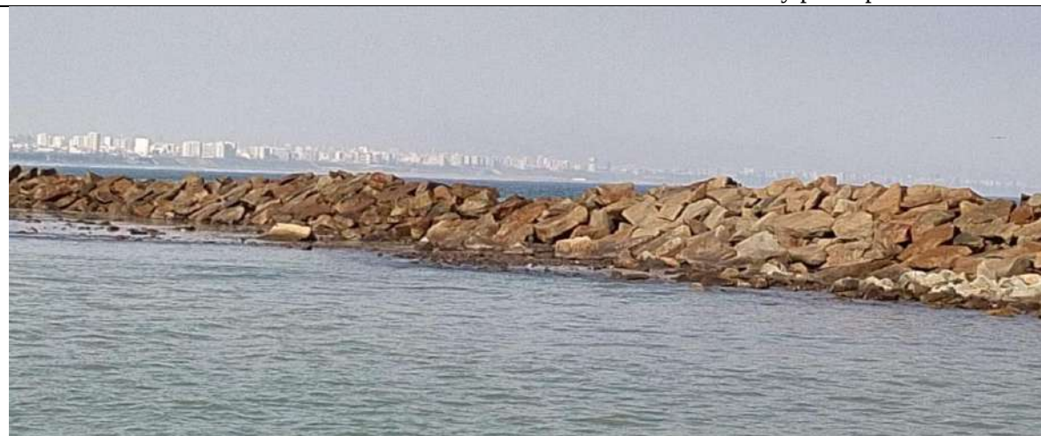
Rompeolas de la Bocana Arenilla erosionado, debilitado por donde atraviesan el oleaje anómalo llegando a las áreas verdes, viales y edificaciones cercanas.
