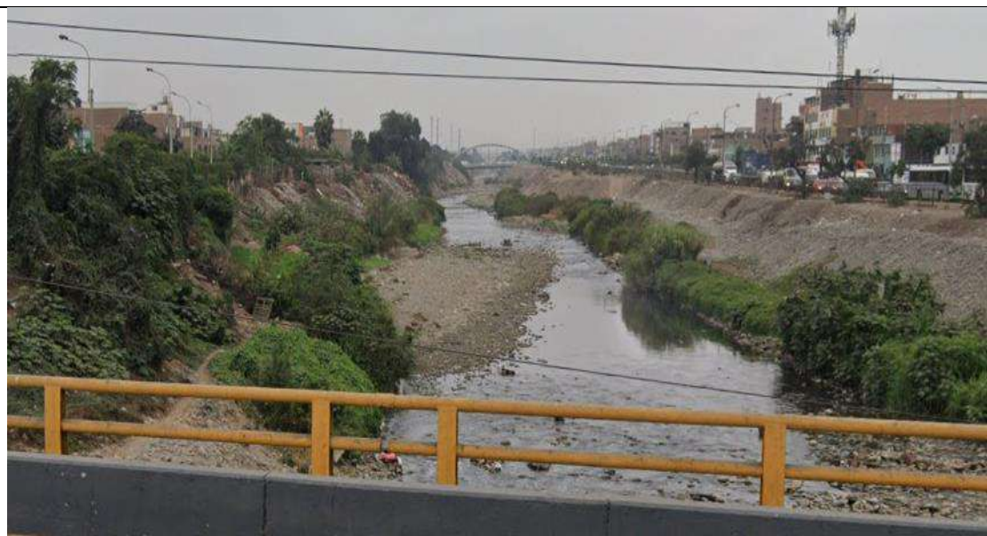
Puente peatonal y vehicular de la Av. Faucett se puede apreciar que el cauce del río Rímac está colmatado, le falta mantenimiento.
