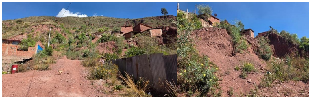
FOTOGRAFÍA 34: VIVIENDAS UBICADAS SOBRE LADERAS INTERVENIDAS MEDIANTE CORTES ESCALONADOS EN DEPÓSITOS POCO CONSOLIDADOS, SIN OBRAS DE SOSTENIMIENTO – Mz A, B DE LA APV. MOLLEMOLLEYOC.
