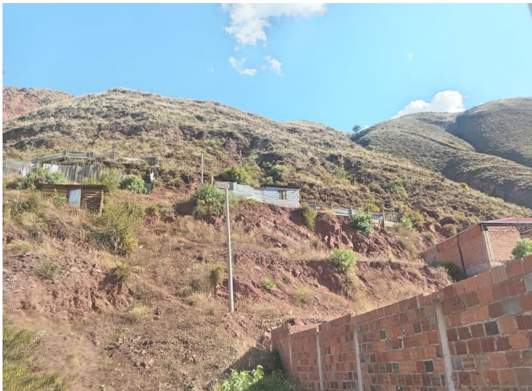
FOTOGRAFÍA 33: CORTES DE TALUD SIN NINGUNA OBRA DE SOSTENIMIENTO – Mz H E I DE LA APV MOLLEMOLLEYC.
