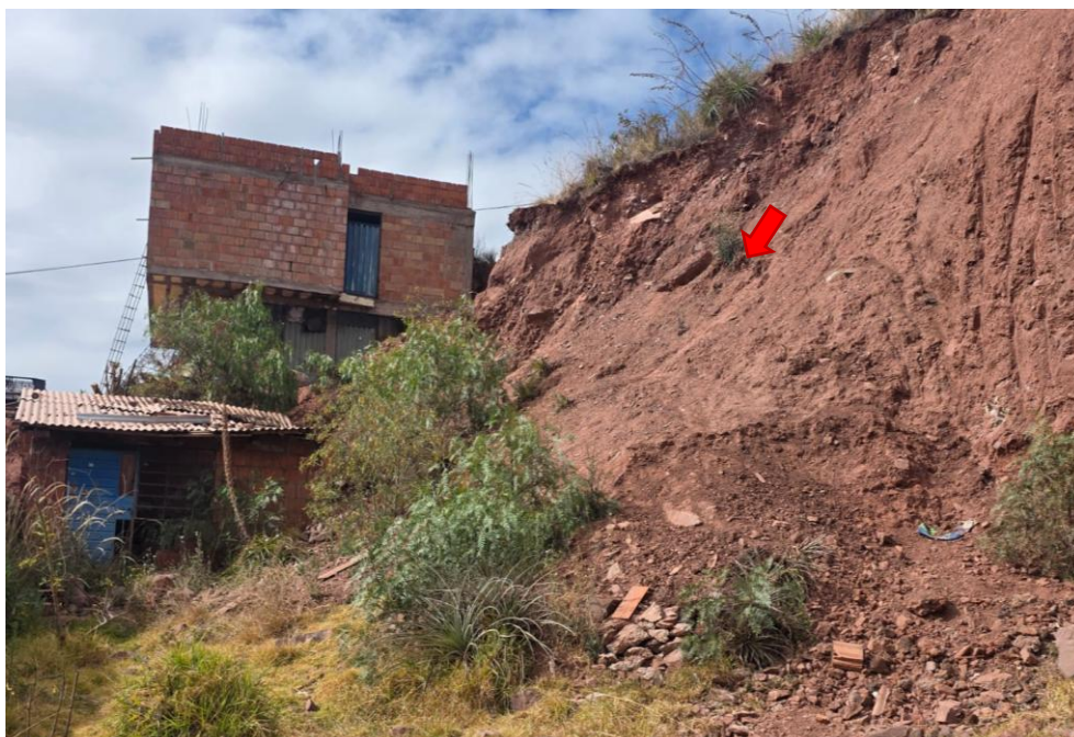
FOTOGRAFÍA 25: DESLIZAMIENTO DE SUELOS EN LA PARTE SUPERIOR DEL SECTOR DE MOLLEMOLLEYOC
