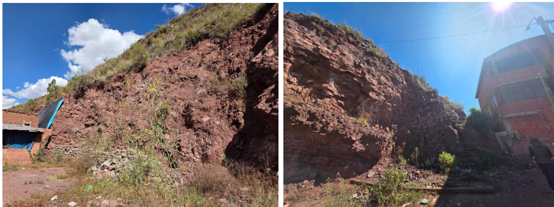
FOTOGRAFÍA 32: VIVIENDAS UBICADAS AL PIE DEL TALUD ROCOSO, EXPUESTA A POSIBLES CAÍDAS DE ROCAS – Mz F, APV. MOLLEMOLLEYOC
