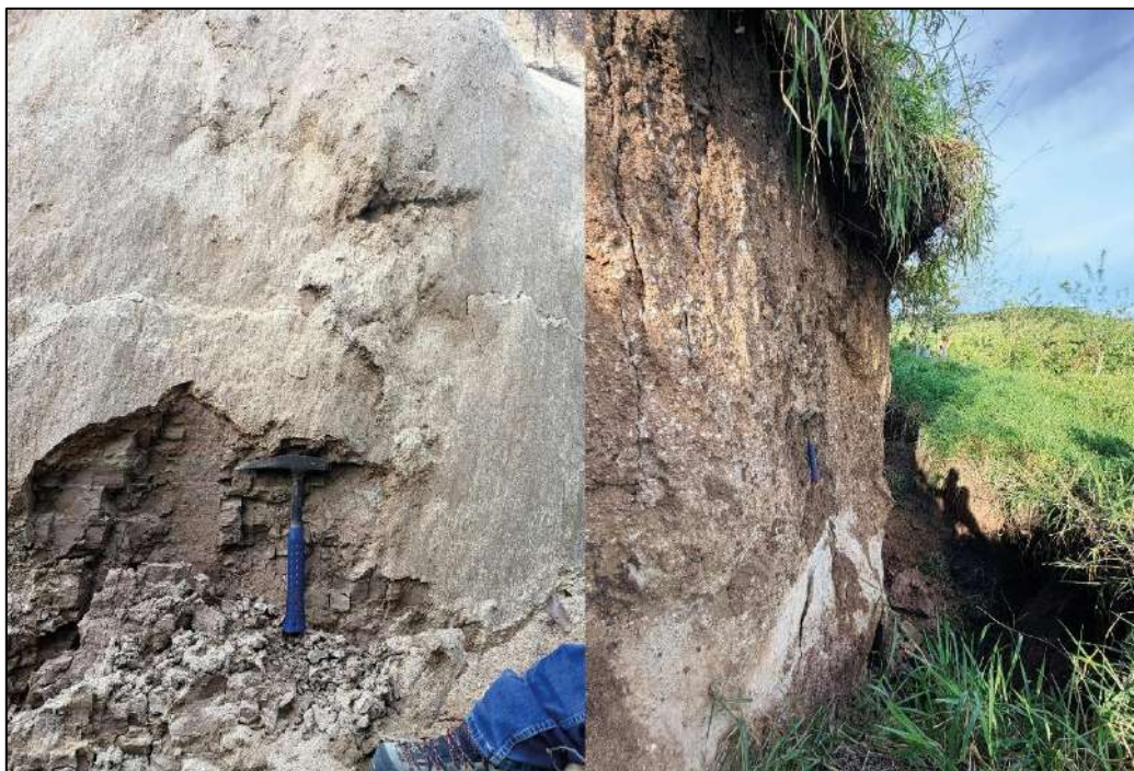
Figura 29: las imágenes muestran las rocas de la Formación Ipururo intensamente meteorizadas debido a la infiltración de aguas. Izquierda: (Coordenadas UTM – 18s 9261705 N, 313480 E). Derecha: (Coordenadas UTM – 18s 9261456 N, 313504 E).
