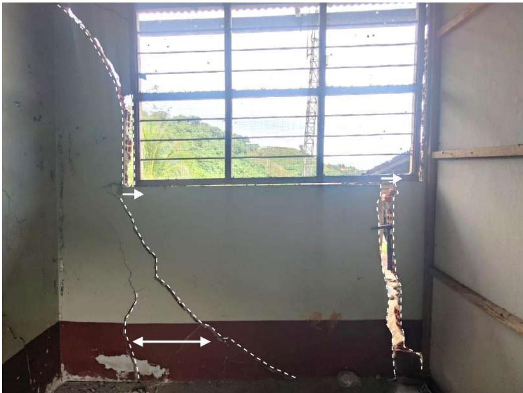
Figura 23: Muro de la institución educativa con abertura de hasta 10 cm, dejando en riesgo de colapso dicha infraestructura.
