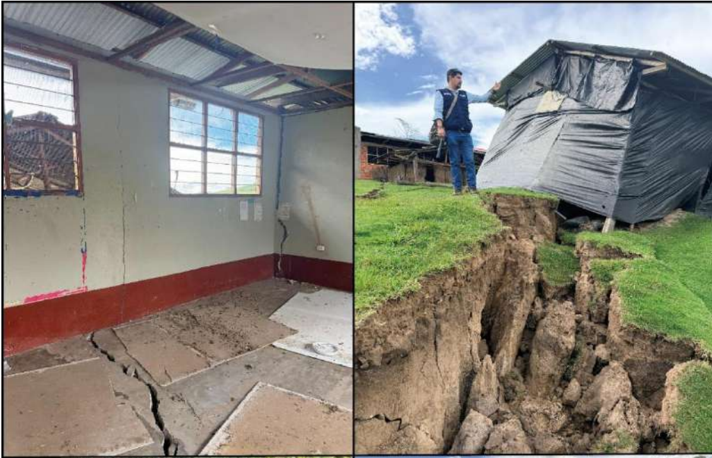
Figura 22: Institución educativa y vivienda afectadas por agrietamientos en los muros y suelo.
