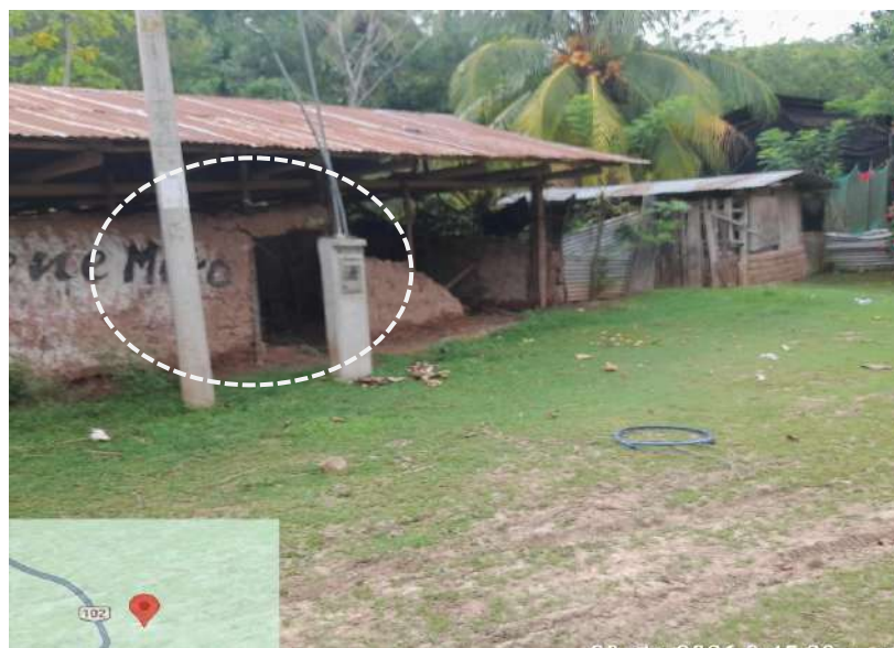
Foto N° 17: Servicio de electricidad en las viviendas y la vía pública.
