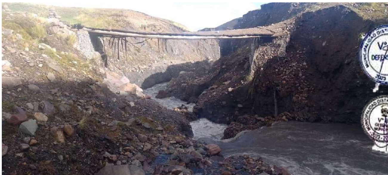
Imagen 52. Vista de afectacion de puente peatonal, por peligro de lluvias intensas
