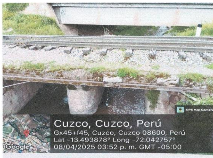
fotografía 43: Estructuras como punto de obstrucción
