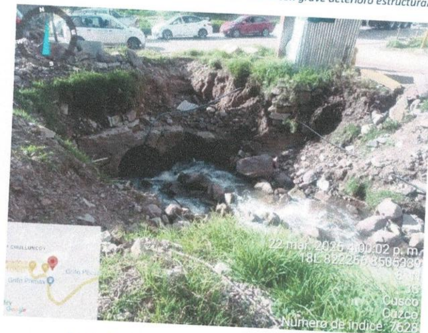
Fotografía 16: Sistema de alcantarillado en estado crítico con grave deterioro estructural
