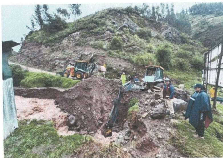
Imagen 5: Colmatación de material detrítico en la Quebrada Chuspiyoq Huayco
