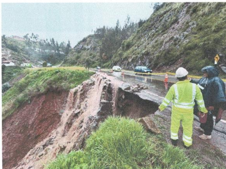
Imagen 6: Afectación de la vía de tránsito Cusco-Abancay
