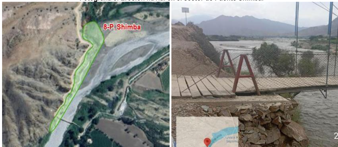
Fotografía 8. Erosión fluvial en el sector de Puente Shimba.
