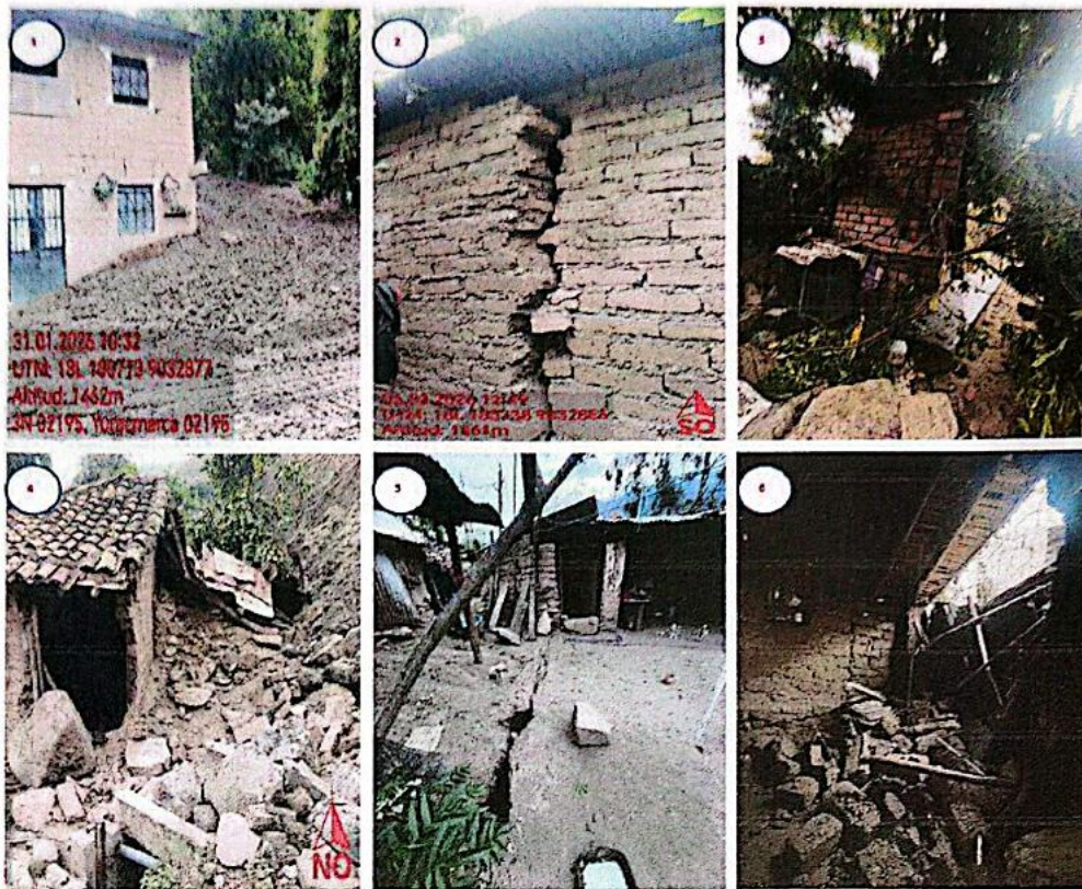
Ilustración 11. Imágenes del deslizamiento, de las viviendas del sector Parcay.
