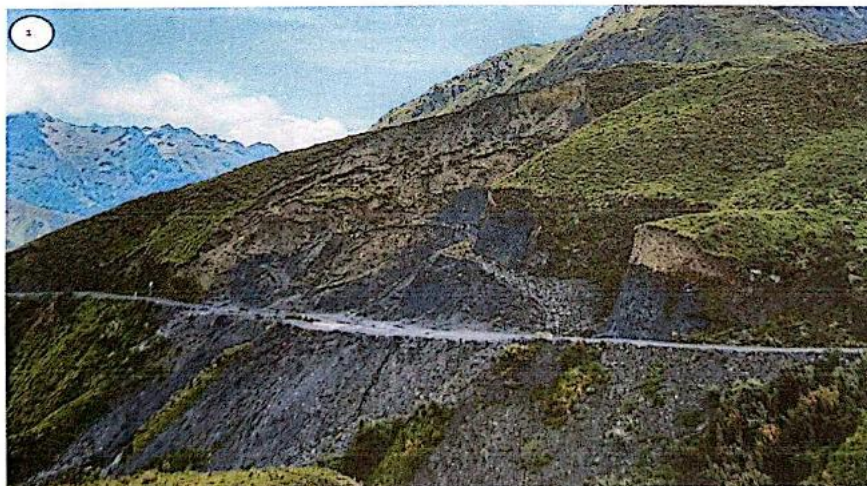
Ilustración 15. Imagen del deslizamiento en el sector Racuay.
