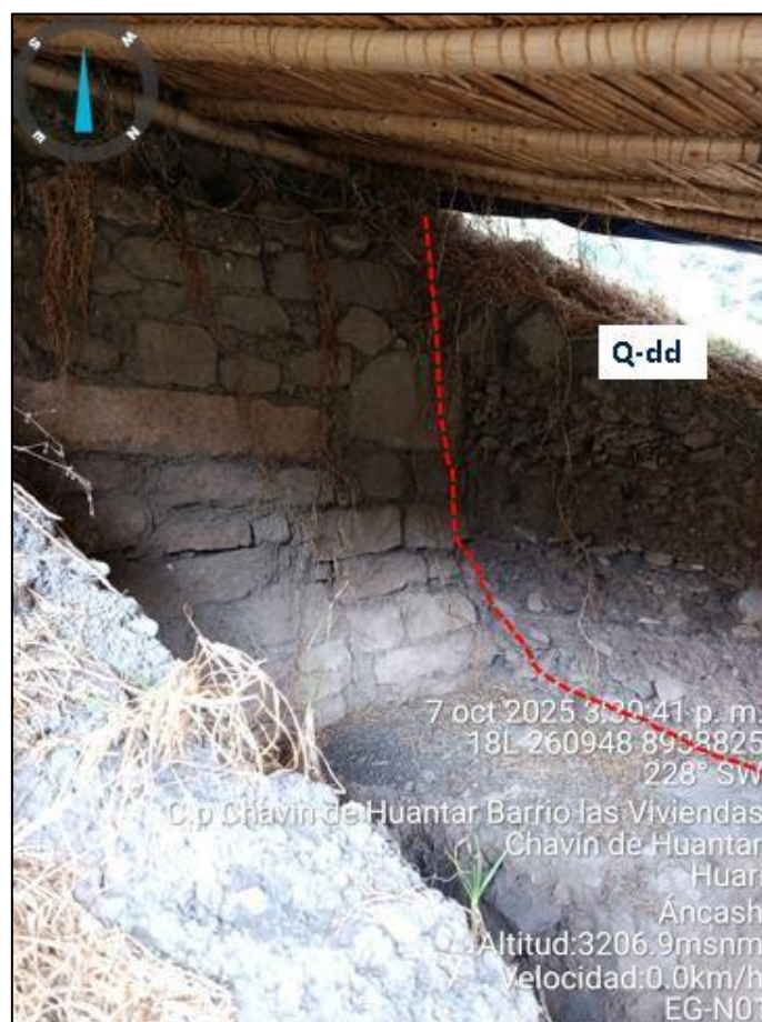
Figura 74. Depósitos coluvio deluviales sobre construcciones Chavín Fuente: Equipo Técnico EVAR Monumento Arqueológico Chavín de Huántar (2025)
