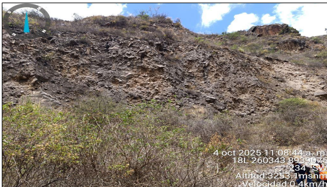
Figura 20. Corte de quebrada en el río Huachecsa mostrado taludes cuasi verticales de depósitos coluvio deluviales
