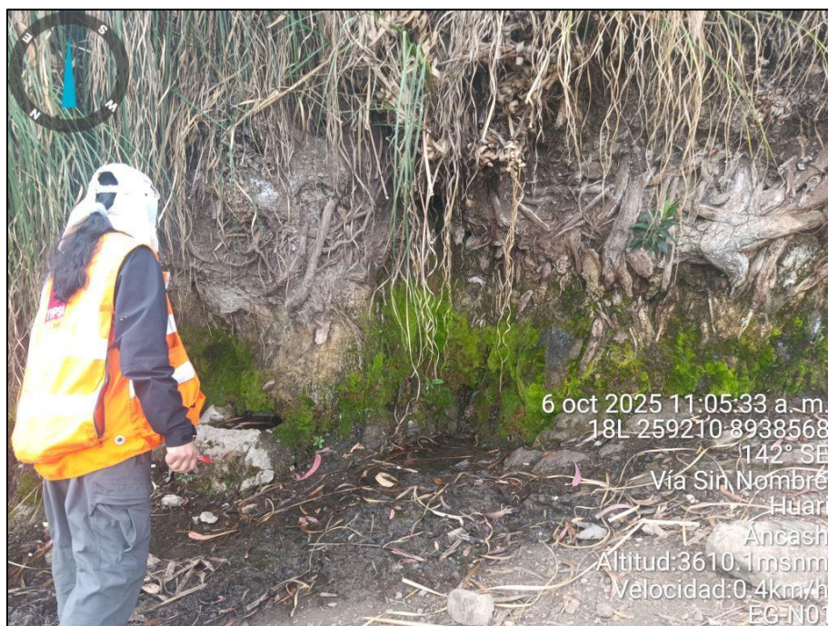
Figura 90. Escarpa lateral derecha del deslizamiento con surgencia de agua Fuente: Equipo Técnico EVAR Monumento Arqueológico Chavín de Huántar (2025)
