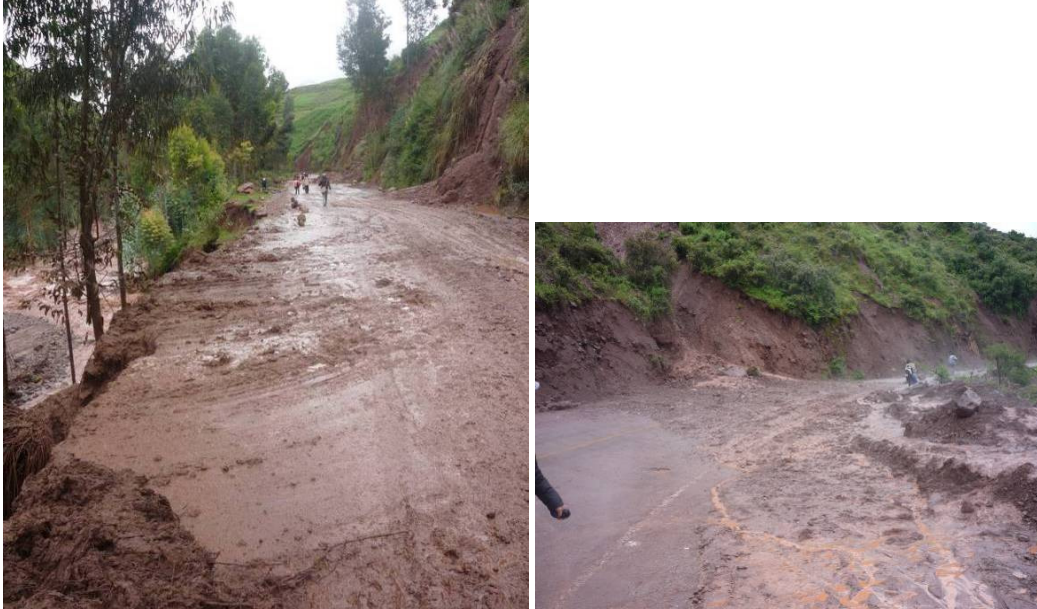
Foto 15 y 16: Derrumbes en el talud de la carretera Cusco-Pisac.
