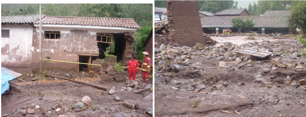
Fotos 32 y 33: Viviendas colapsadas debido al remojamiento de sus bases durante la inundación.
