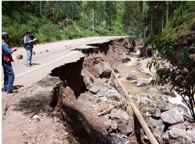
Foto 14: Colapso parcial de la plataforma de la carretera tras un intenso socavamiento lateral.
