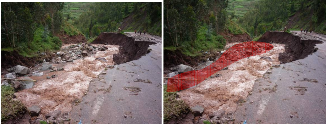
Fotos 12 y 13: Socavamiento intenso producto de un desembalse violento en una zona de estrangulamiento.
