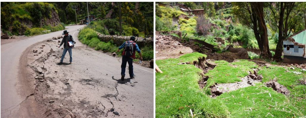
Fotos 19 y 20: Grietas en la carretera y en el poblado de Huancalle, que indican un movimiento de toda la ladera como consecuencia del socavamiento en la parte baja, así como también de la infiltración de agua tras las intensas lluvias.
