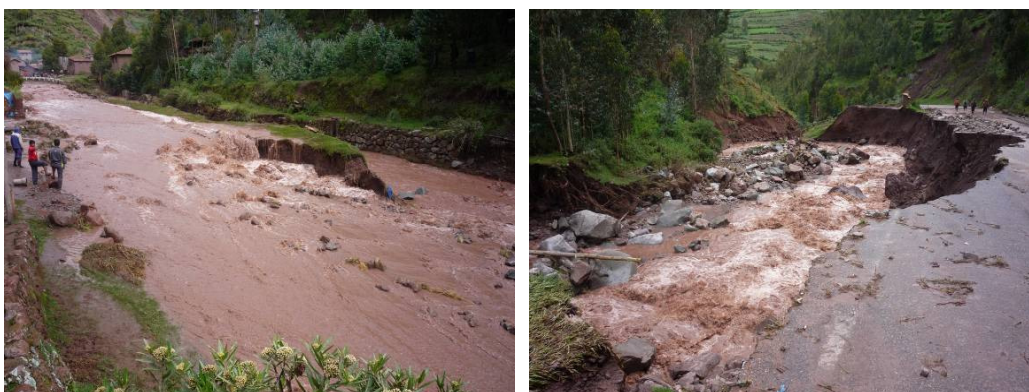
Fotos 7 y 8: Colapso e inundación de la carretera Cusco Pisac.
