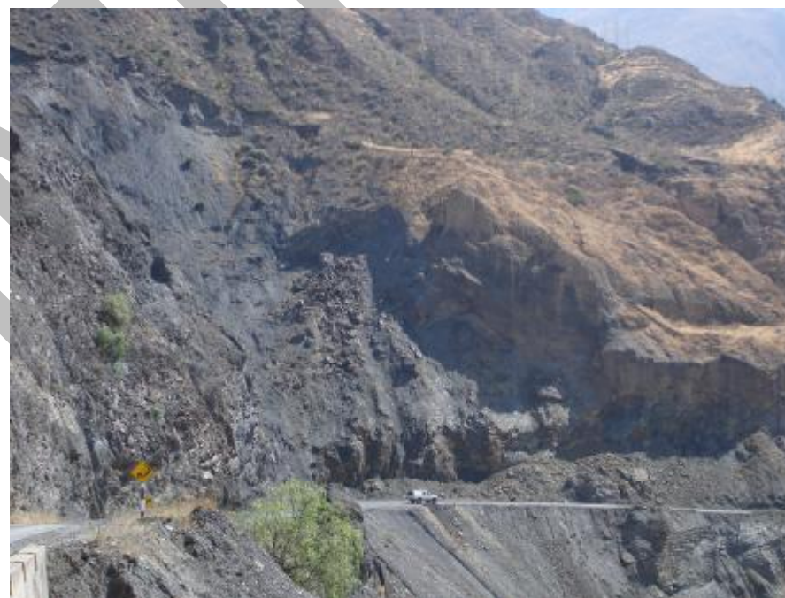
Foto N° 16: Tramo de la Carretera del Cañón del Pato, afectada por caídas de rocas y deslizamientos
