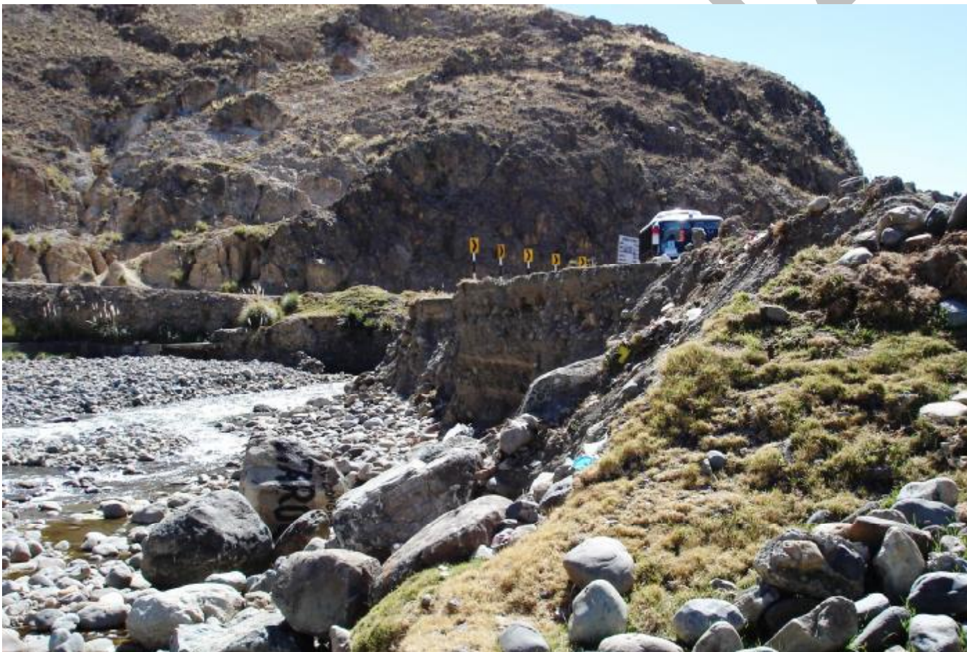
Foto N° 34 Erosión fluvial del río Santa, que afecta varios tramos de la carretera Conococha - Huaraz
