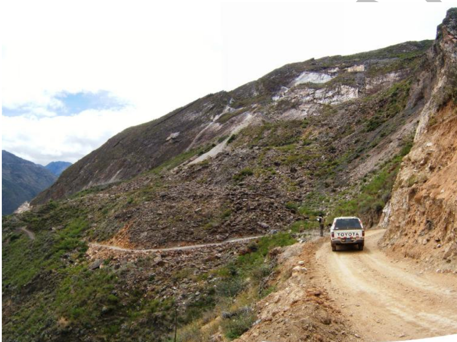
Foto N° 8 Avalancha de rocas en el sector entre Yauya y San Nicolás. Su reactivación con sismo compromete tramo de carretera.
