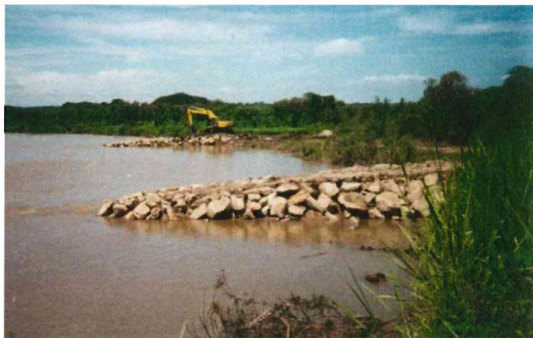
Imagen N° 15: Protección con espigones de gaviones
