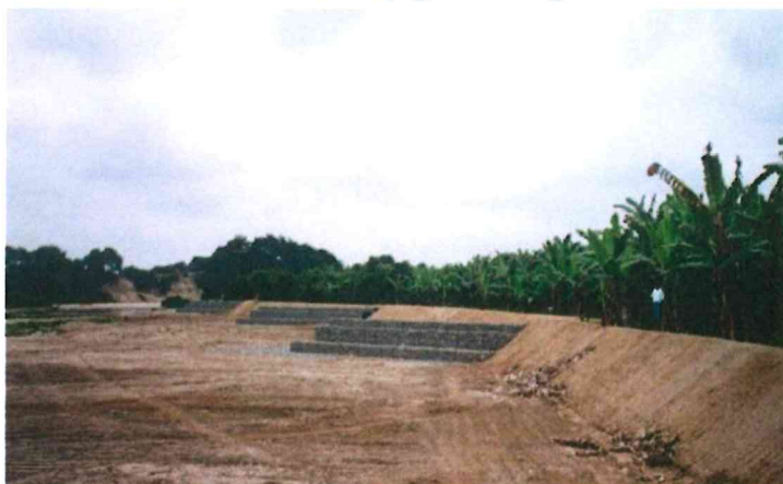
Imagen N° 14: Protección con espigones de gaviones
