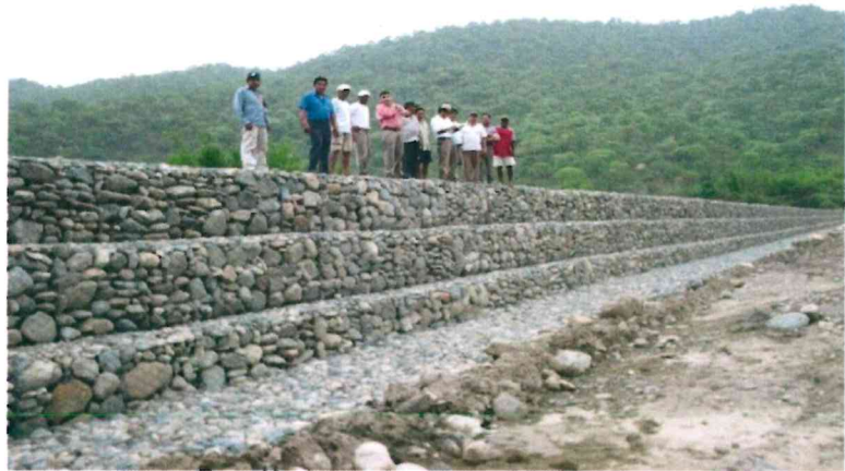
Imagen N° 13: Protección con gaviones
