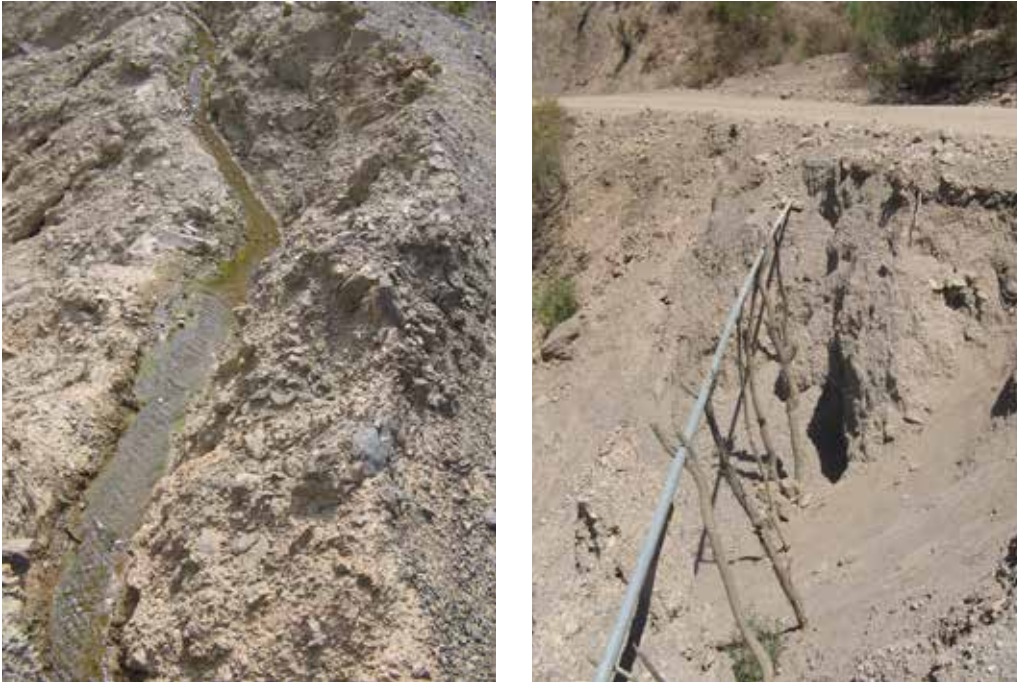
Canal de riego en tierra y sin diseño adecuado (izquierda) y línea de conducción frágil por diseño inadecuado (derecha), ambas expuestas a la ocurrencia de probable deslizamiento.
