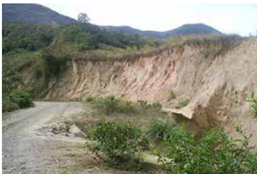
Tramo en riesgo
