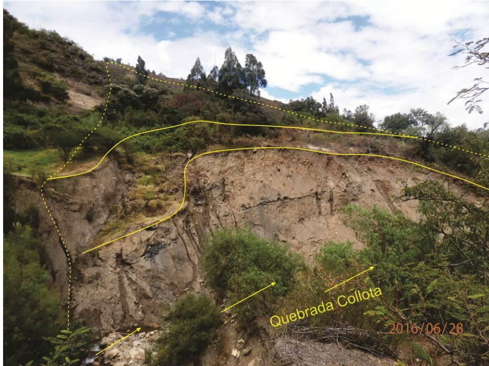
Foto 8. Vista tomada con dirección este, se observa la parte inferior del deslizamiento Cachipampa.
