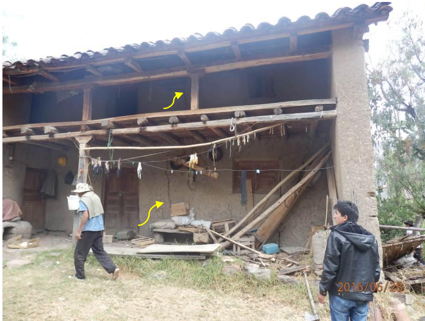
Foto 10. Vista tomada a la vivienda afectada con grietas vertical en la pared (fecha amarilla).
