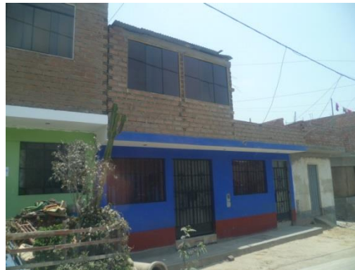
Figura 17. Vivienda de albañilería de dos pisos con cubierta ligera en el último nivel.
