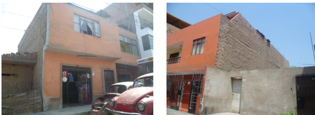
Figura 29. Viviendas informales sin columnas de confinamiento.
