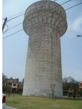
Figura 128. Tanque de agua del sector 08.
