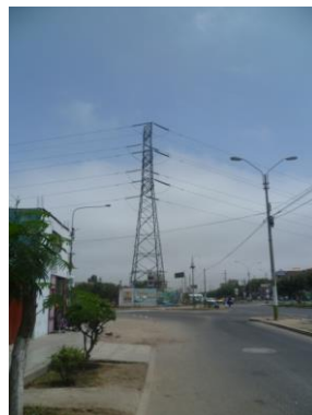
Figura 127. Torre de Alta Tensión del sector 08.
