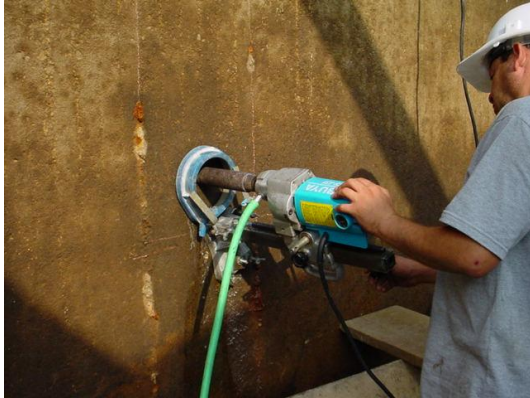
Figura 177. Extracción de testigos de concreto endurecido. Obsérvese la corrosión en el muro.
