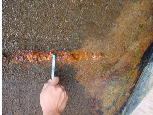
Figura 178. Corrosión del refuerzo en los muros de los decantadores.
