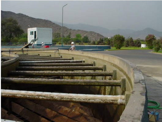
Figura 179. Vista de un decantador.
