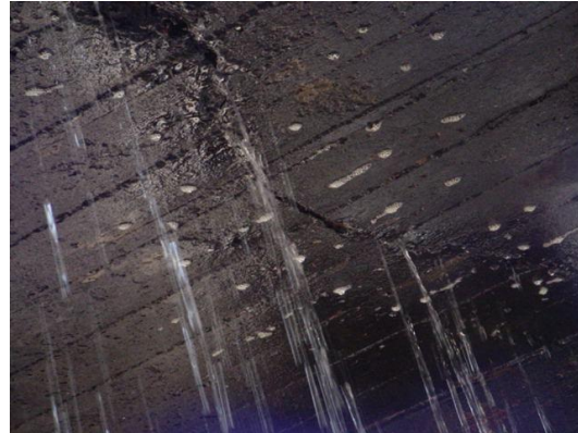
Figura 180. Fisuras en canal de salida del decantador.
