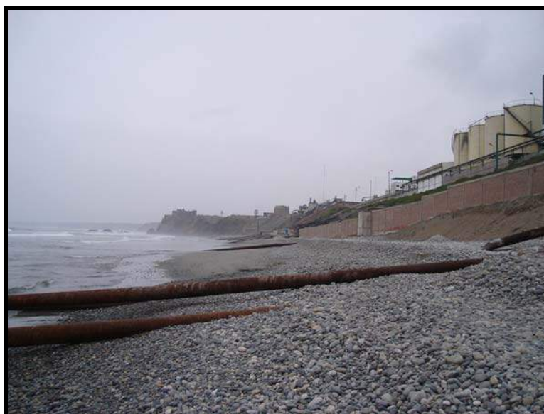
Foto 27: Tuberías de los emisores submarinos para descargas de agua de bombeo de empresas pesqueras.
