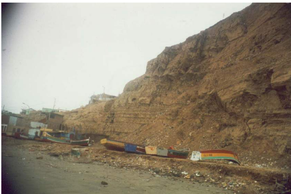
Foto 11: Roca sedimentaria en Punta La Viuda (Puerto de Huacho), muy fracturada, con desprendimiento por descompresión y más aún por sismo importante.
