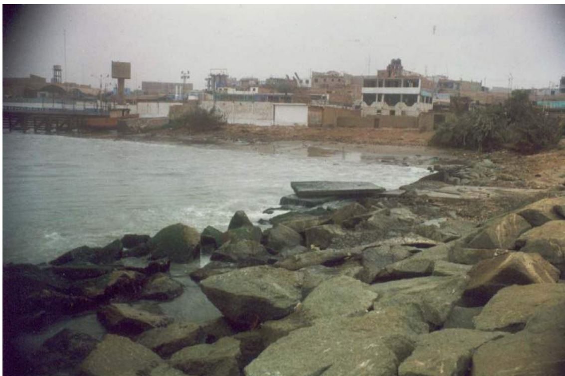
Foto 12: Enrocado en el lado sur de la bahía de Huacho, para evitar la erosión del talud por oleaje permanente.
