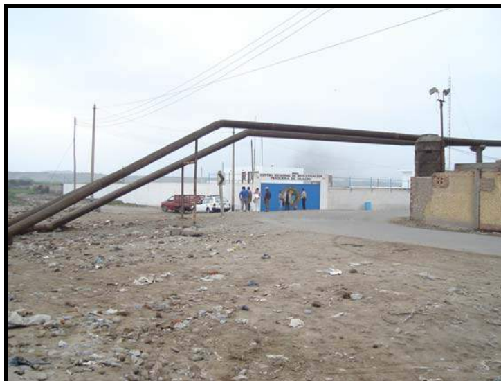
Foto 21: Tuberías del emisario submarino para descargas de aguas residuales de empresas pesqueras.
